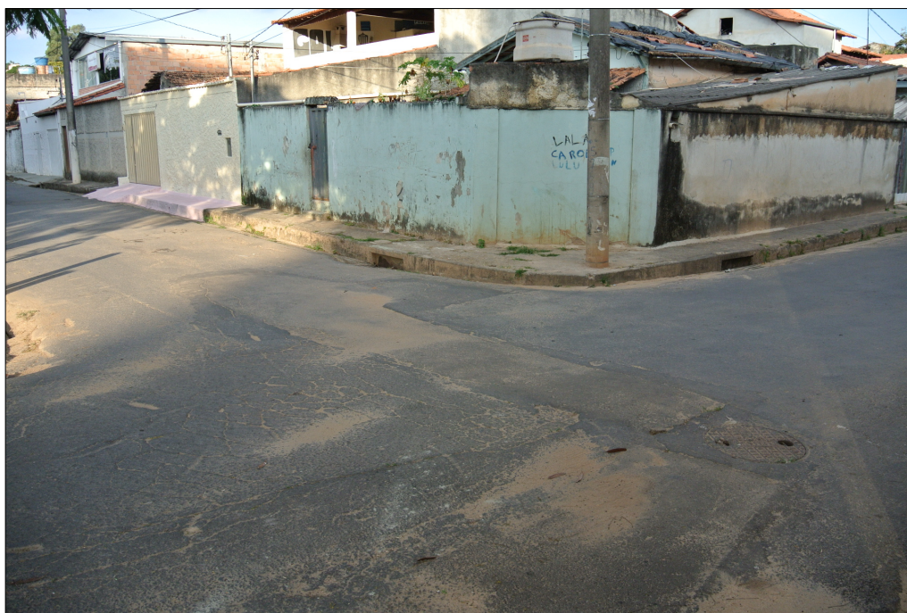
Figura 51 – Bairro Conjunto Lagoa: calçadas irregulares e bueiro com ocorrência de refluxo no período chuvoso, segundo indicado pelos habitantes (Foto: Camila Yarla, Abril de 2018).
