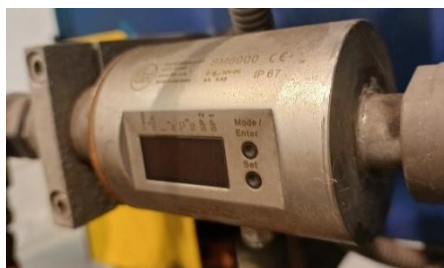
Figura 21 – Medidor de vazão de água da marca IFM, modelo SN6000.
