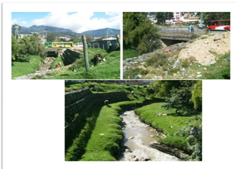
Fotografia 18- Obras de mitigação de impactos (gabiões) e disposição final de escombros nas áreas das faixas de proteção
