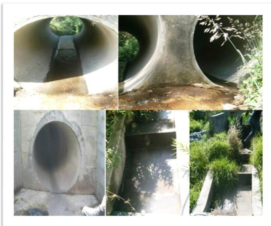
Fotografia 7 – Obras inacabadas e sem manutenção por parte das entidades competentes
