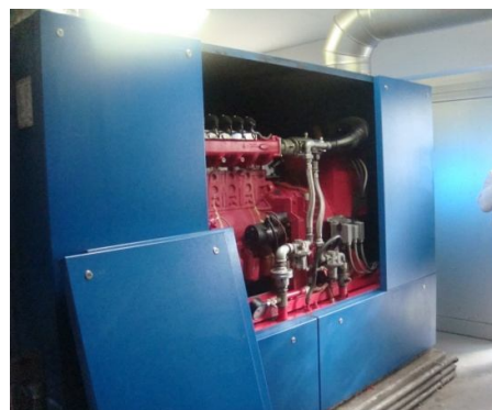
Figura 1-24: Vista do motor de cogeração da Taunusstein, Alemanha.
