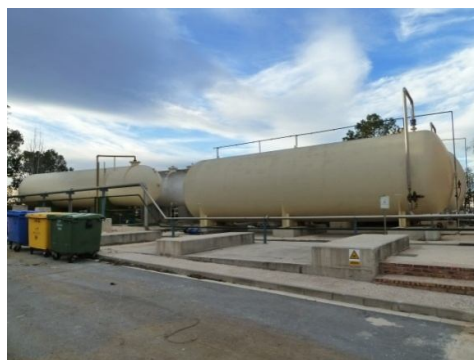
Figura 5-14: Gasômetros para armazenamento de biogás na ETE Rincón de León, Alicante. Fonte: Autor
