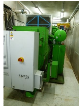
Figura 5-20: Vista geral do motor de combustão interna da ETE Pinedo 2, Valência.
