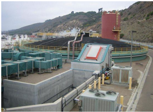
Figura 1-17: Detalhe do digester de lodo da ETE de Point Loma (EUA) Fonte: FEMP (2004)
