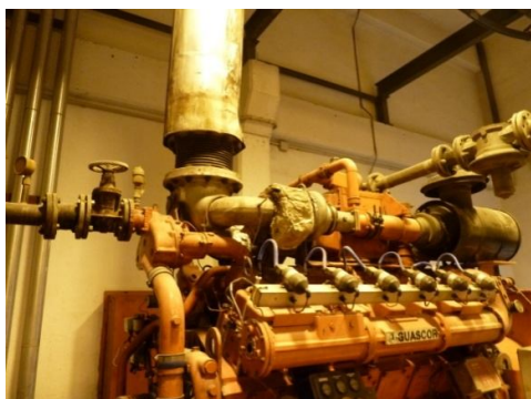
Figura 5-13: Vista geral do motor de combustão interna da ETE Rincón de León, Alicante. Fonte: Autor
