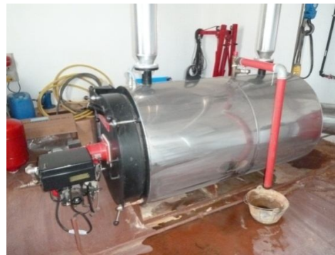
Figura 5-4: Caldeira a biogás, ETE Novelda, Monfort del Cid.
