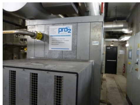
Figura 5-7: Estação de cogeração por motor de combustão interna, ETE Valorhin, Estrasburgo. Fonte: Autor
