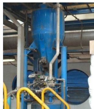
Figura 5-17: Torre de lavagem dos gases gerados no incinerador de lodo na ETE de Pinedo 1, Valência. Fonte: Autor
