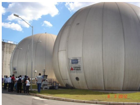
Figura 1-28: Gasômetros para armazenamento de biogás na ETE Arrudas.
