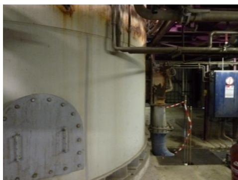
Figura 5-8: Forno de incineração para lodo e biogás da ETE Valorhin, Estrasburgo. Fonte: Autor
