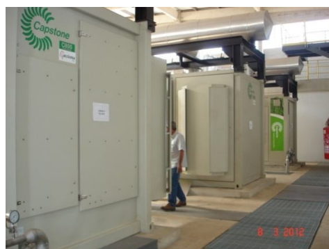
Figura 1-27: Série de microturbinas em funcionamento na ETE Arrudas.
