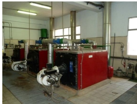
Figura 5-12: Sequencia de caldeiras para o aquecimento do lodo, ETE Rincón de León, Alicante. Fonte: Autor
