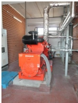
Figura 5-3: Vista geral do motor de combustão interna da ETE Novelda, Monfort del Cid.
