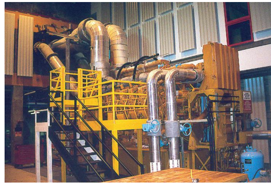
Figura 1-18: Motor alimentado por biogás na ETE de Point Loma (EUA) Fonte: FEMP (2004)
