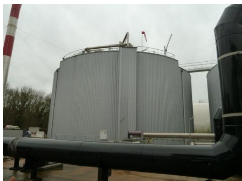
Figura 5-6: Vista geral do biodigestor de lodo da ETE Valorhin, Estrasburgo. Fonte: Autor
