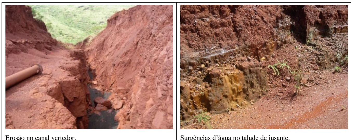
Figura 41. Inconformidades da Barragem I - Mina de Casa Branca (2008).
