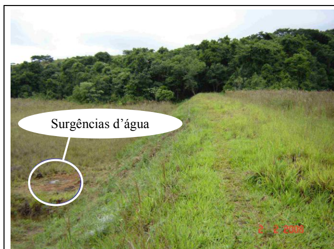
Surgências d'água no pé do talude de jusante (2006).
