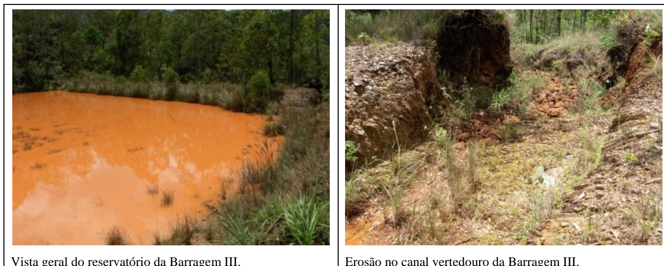
Figura 43. Inconformidades da Barragem III - Mina de Casa Branca (2008).
