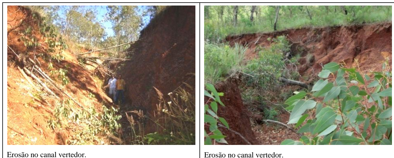
Figura 42. Inconformidades da Barragem II - Mina de Casa Branca (2008).
