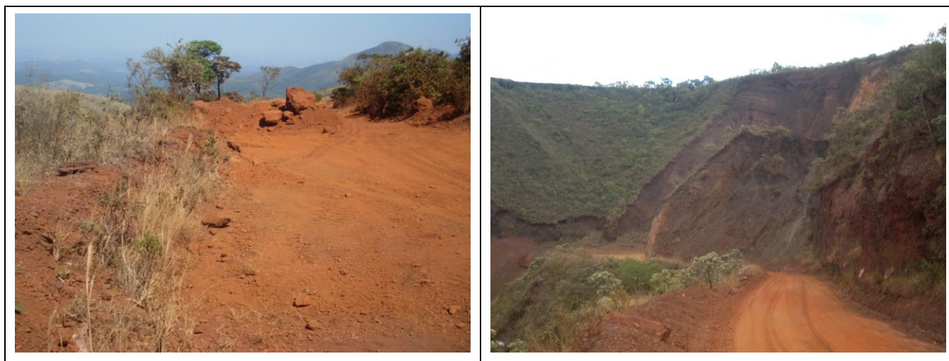
Figura 53. Inconformidades das vias de acesso secundárias da Mina de Casa Branca (2010).
