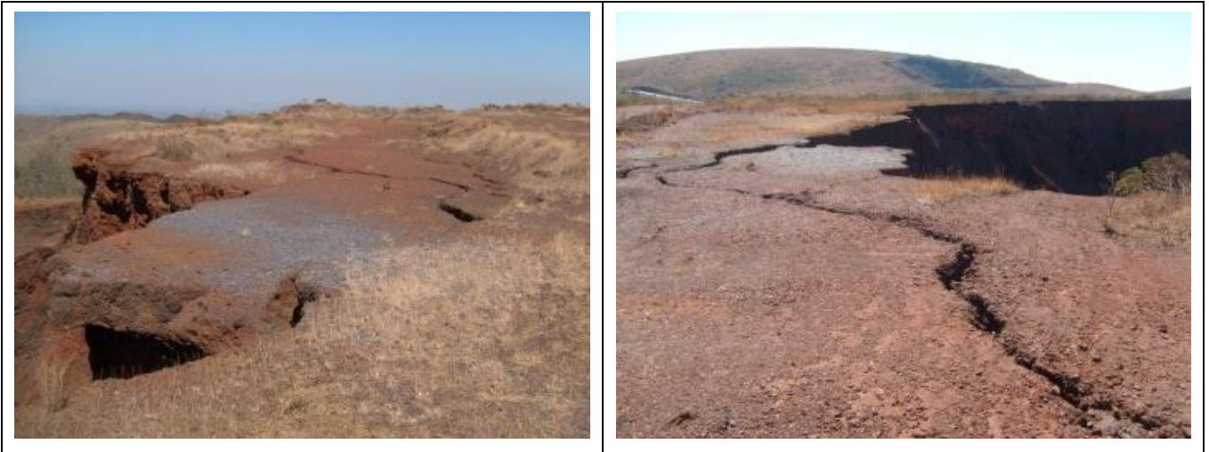
Figura 45. Trincas nas bordas das cavas (2010).
