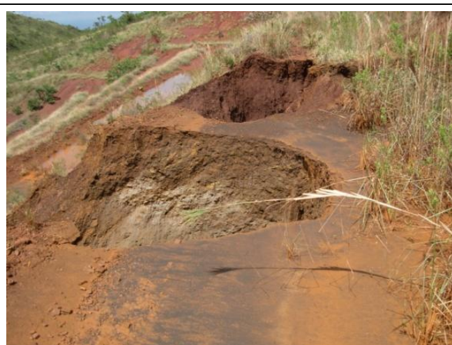
Erosão no talude de jusante.
