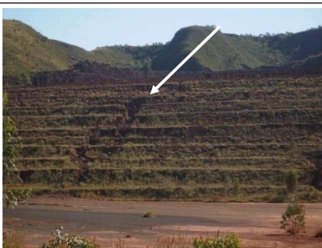
Em detalhe, indicação da erosão no talude de jusante.
