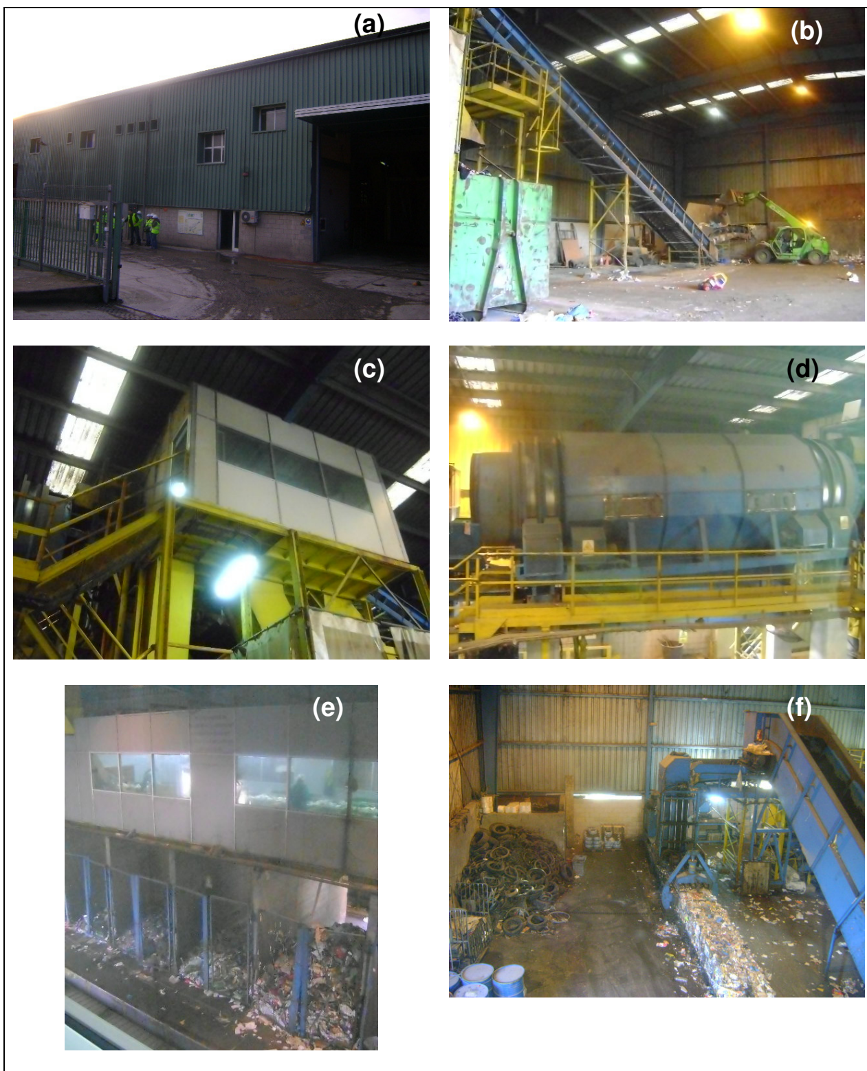
Figura 5.17 – Principais partes da Unidade de Triagem de Molins de Rei – Vista externa da unidade (a), Recepção (b), Separação manual 1 (c), Peneira rotativa (d), Separação manual 2 (e), Prensa (f).
