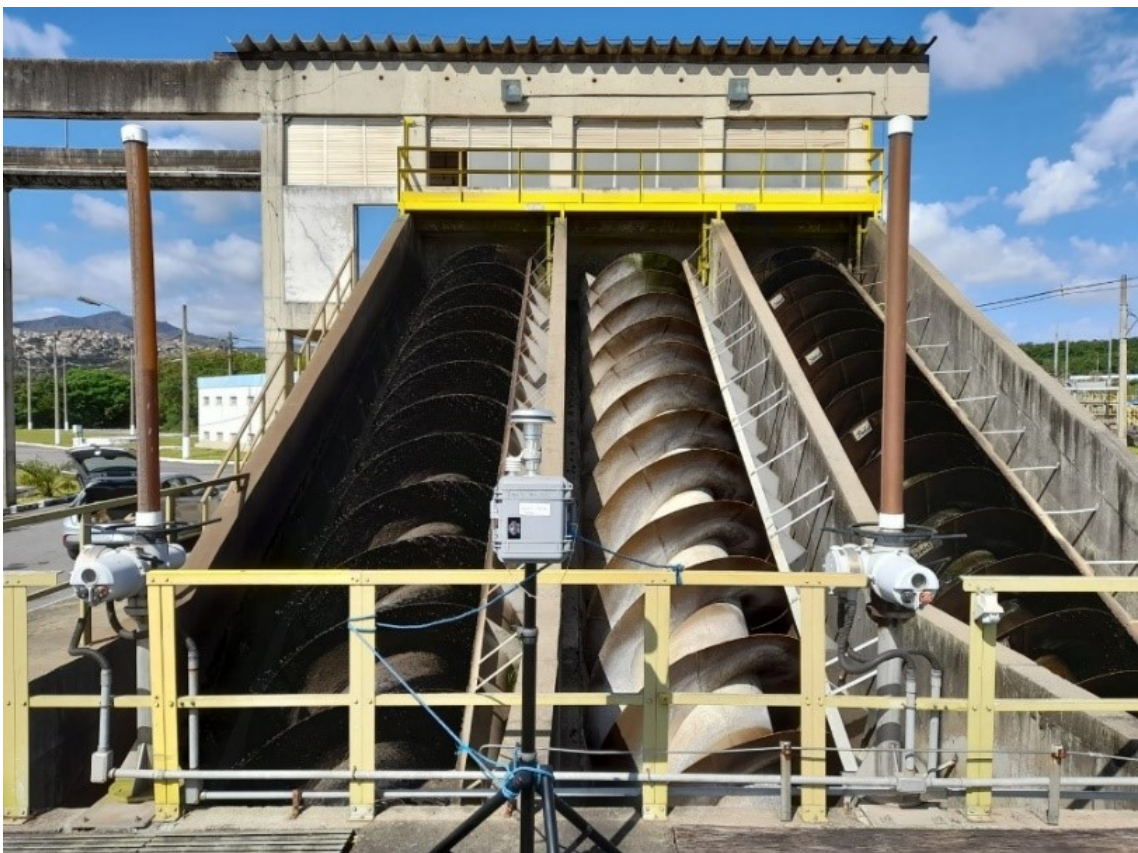
Figura 4.7 – Amostrador de médio volume na elevatória de lodo de retorno
