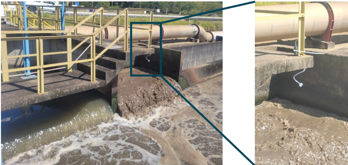
Figura 4.5 – Amostrador de pequeno volume na entrada do lodo de retorno no tanque de lodos ativados
