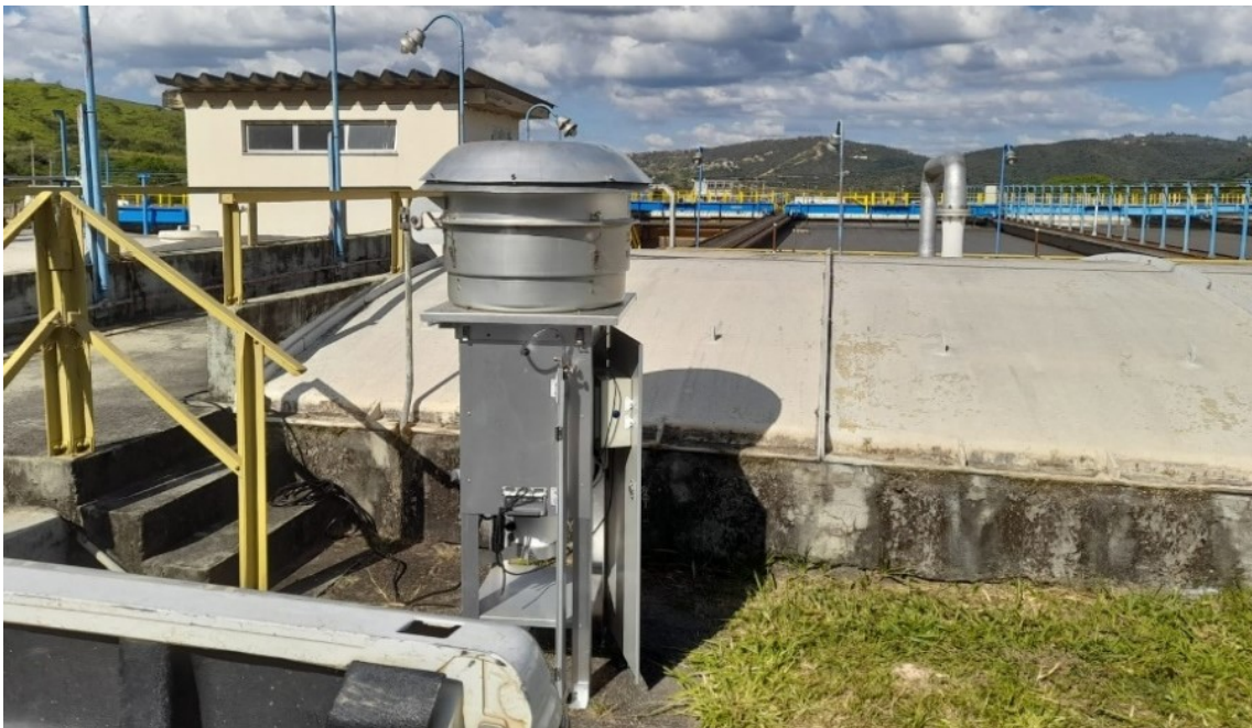
Figura 4.3 – Amostrador de grande volume a jusante da ETE B
