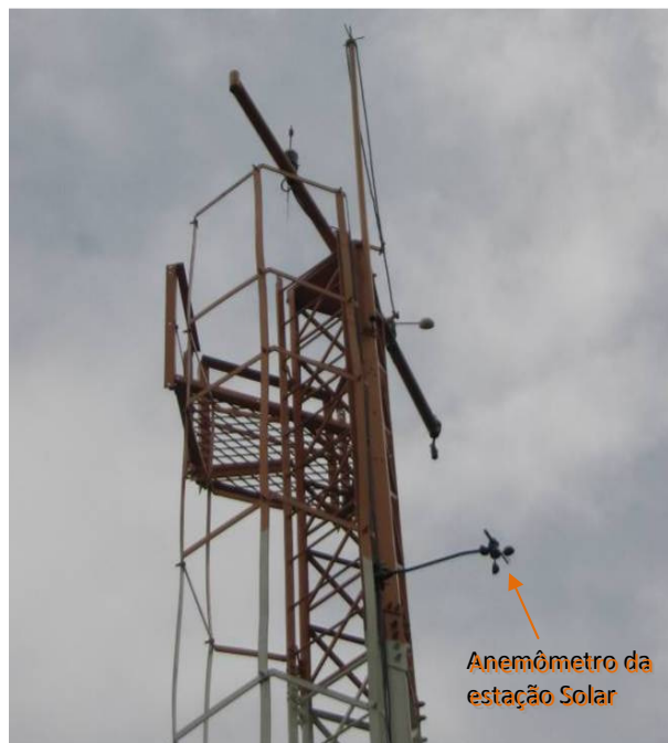
Figura 15 - Foto dos sensores junto à torre metálica da estação climatológica da FEAM. Anemômetro da SOLAR instalado logo abaixo do sensor padrão da estação climatológica
