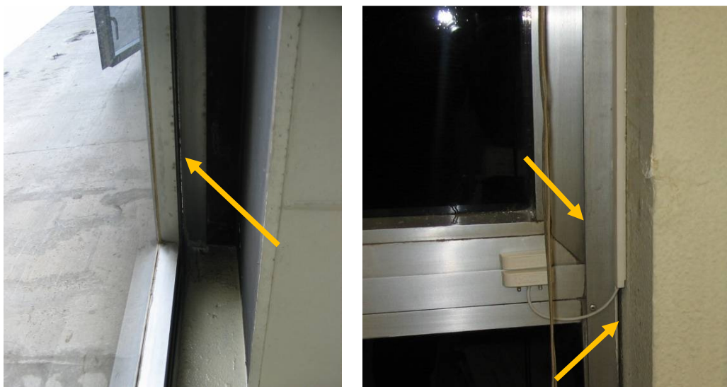
Figura 21 - Fotos dos detalhes das frestas da esquadria (indicadas com setas)
