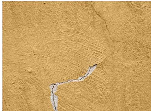
Figura 3: Patologias nas construções. (Fonte: disponível em: goo.gl/WBTkt5 )
