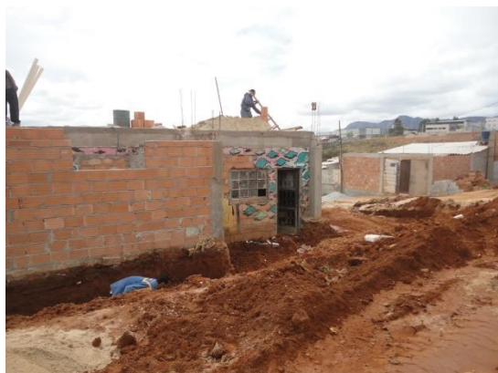
Figura 33: Movimentação de terra desproporcional.
