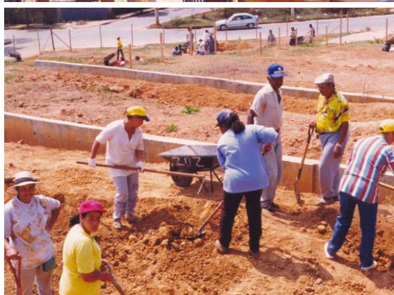
Figura 2: Equipe em momento de aplainamento do solo após finalização de sapatas, no Urucuia.
