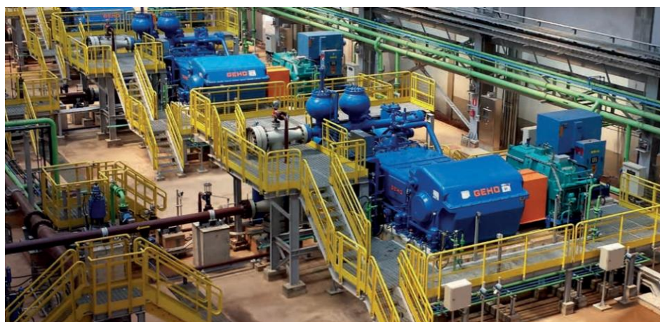
FIGURA 2. 6 – Bombas de deslocamento positivo operando em paralelo
