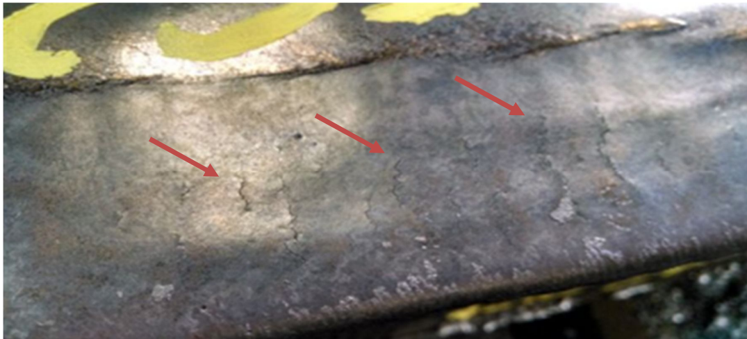
Figura 3.8 – Defeito trinca transversal em placa.
