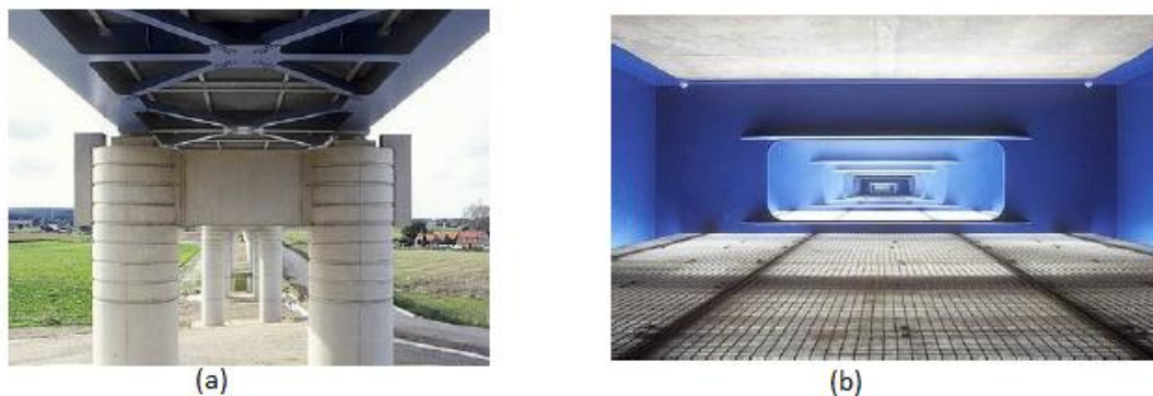
Figura 2.13 – Vista inferior (a) e interior (b) da Ponte la Haute Colme , TGV Nord (Figueiredo, 2007)
