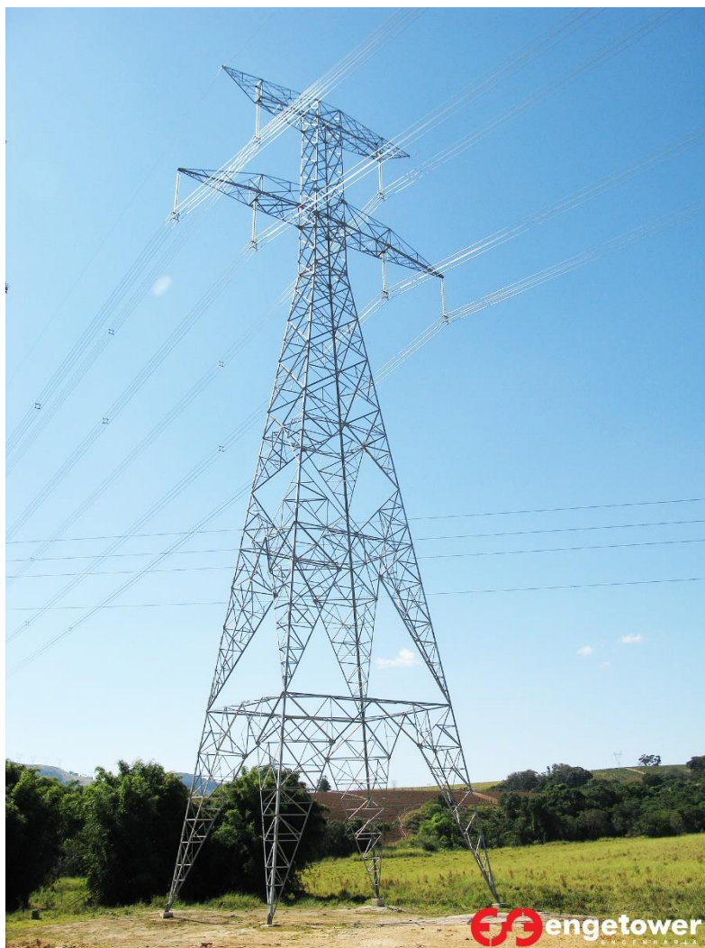
Figura 3.11 – Torre Autoportante Triangular Circuito Duplo “Danúbio”. [8]
