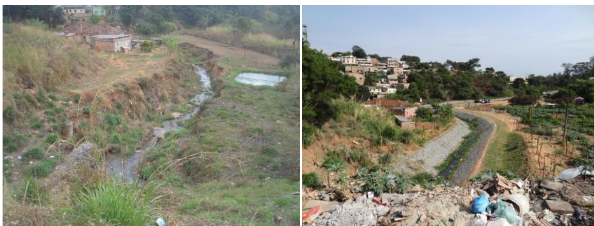
a) margens erodidas
