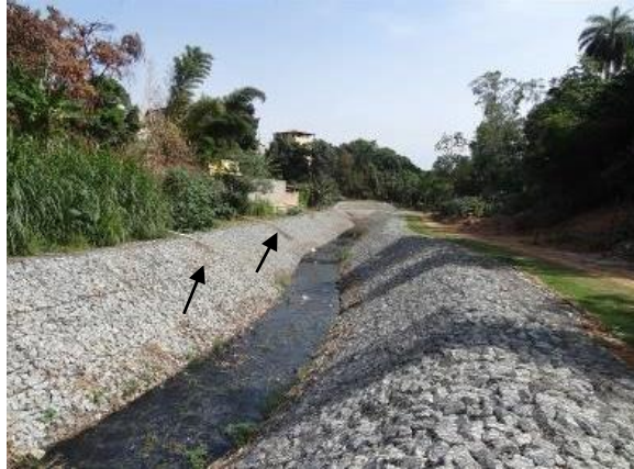
Figura 8-31: Trecho em gabião, lançamentos de esgoto direto das casas das margens
