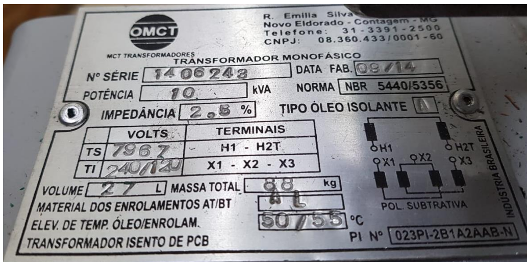
Figura 3.2 – Placa do transformador investigado nesse trabalho.
