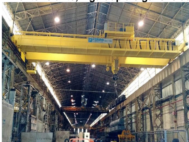
Figura 2.3 – Ponte rolante, viga dupla e gancho auxiliar
