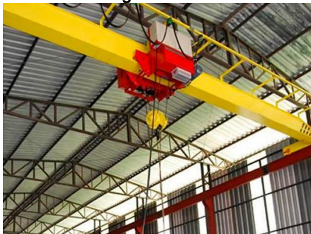
Figura 2.2 – Ponte rolante de viga única e sem cabine de comando
