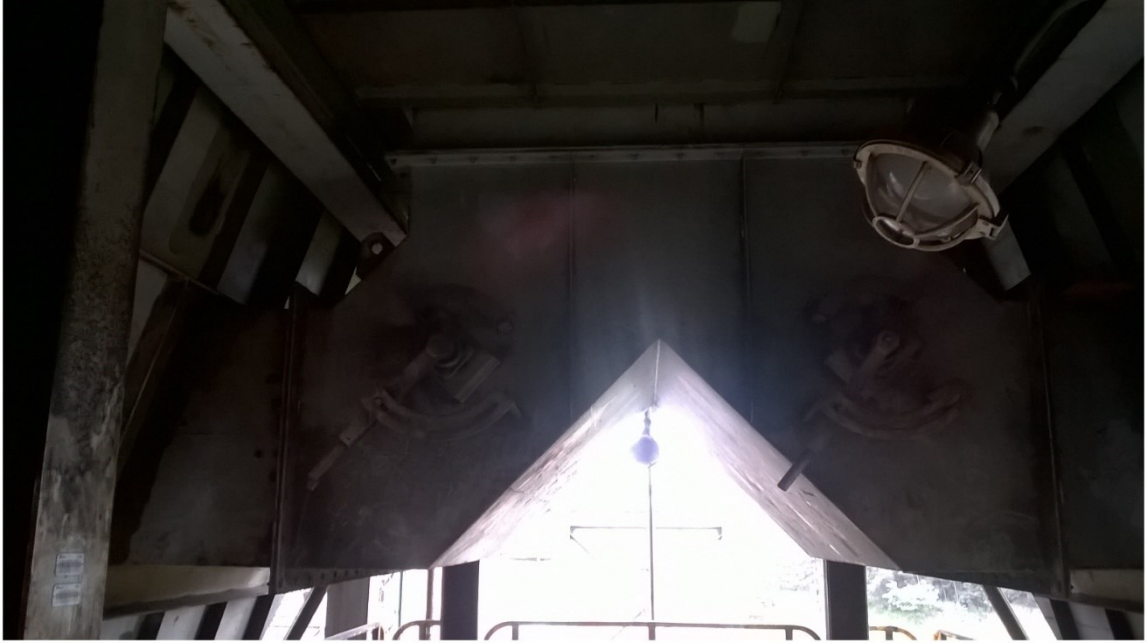
FIGURA 4.3 – Plenum de entrada do filtro FONTE: acervo do autor (2018).
