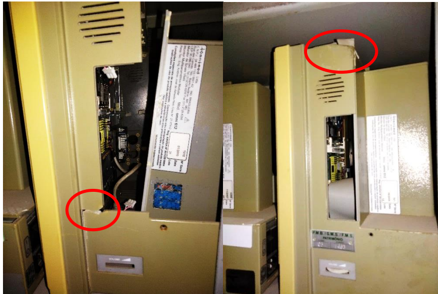
Figura 8 - Monitores com gabinete quebrado/ danificado
