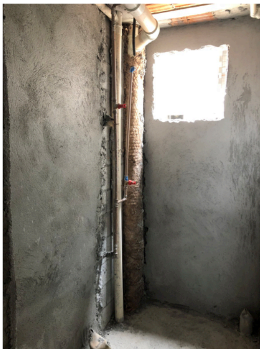
Figura 49 - Tubulações de queda de esgoto e água pluvial envolvidas por lã de vidro Fonte: Acervo pessoal
