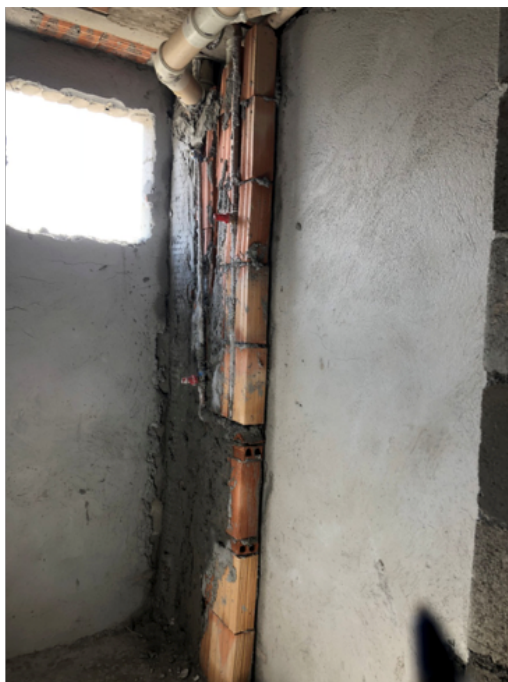
Figura 50 - Shaft de alvenaria de tijolo cerâmico Fonte: Acervo pessoal
