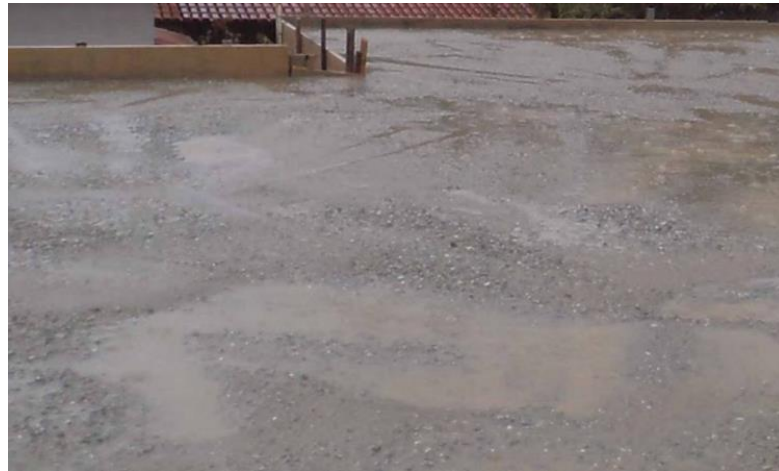
Figura 2.4- Concretagem sob chuva com superfície muito irregular. Fonte: Blog Construindo Meus Sonhos, disponível em www.construindomeussonhos.blogspot.com , acessado em 15/11/2016.
