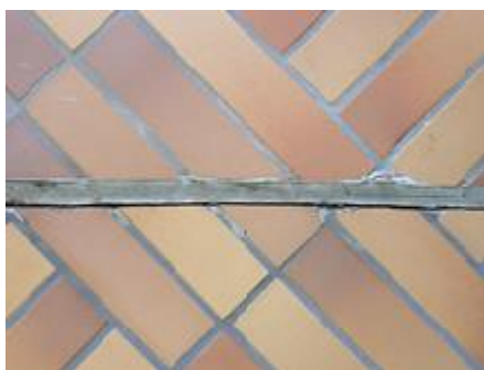
Fig. 4.6 - Falha no Tratamento da Junta
