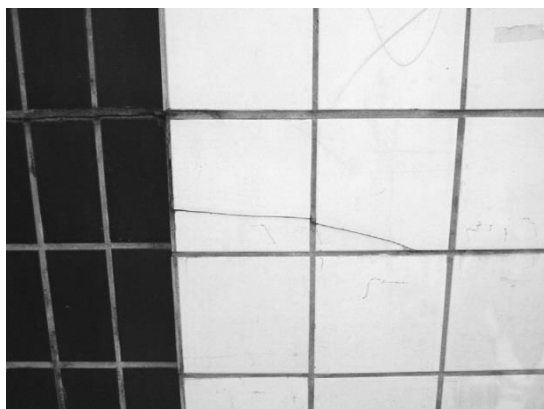
Fig. 4.4 - Trincas de placa cerâmicas
