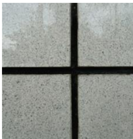
Fig. 4.3 - Manchas no Revestimento
