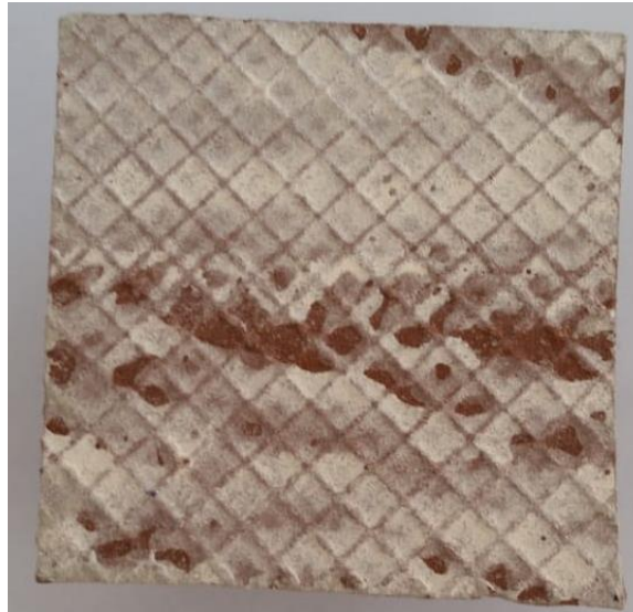
Figura 28 Ruptura do revestimento cerâmico utilizando a argamassa do fabricante 2 do tipo AC-III.
