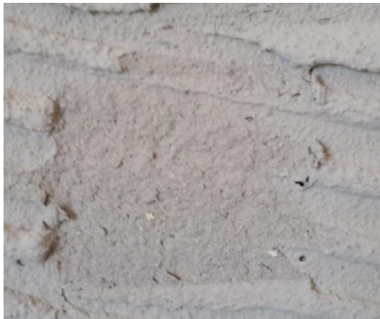
Figura 21 Face da parede de concreto não lavada após ruptura - Argamassa fabricante 1 do tipo AC-II.
