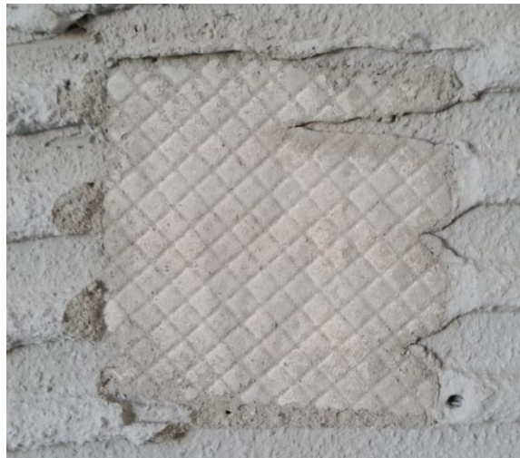
Figura 27 Face da parede de concreto não lavada após ruptura - Argamassa do fabricante 2 do tipo AC-II.
