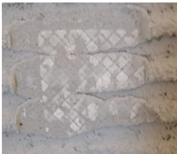
Figura 13 Face da parede de concreto não lavada após ruptura - Argamassa do fabricante 3 do tipo AC-I.
