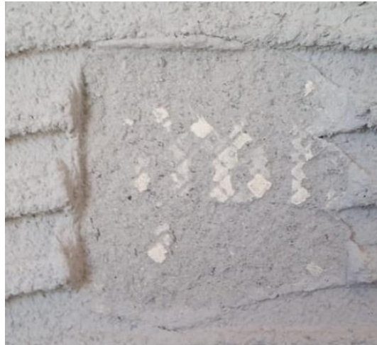
Figura 19 Face da parede de concreto não lavada após ruptura – Argamassa fabricante 1 do tipo AC-I.
