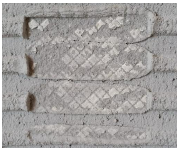
Figura 23 Face da parede de concreto não lavada após ruptura - Argamassa fabricante 1 do tipo AC-III.
