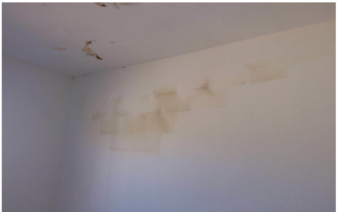
Figura 24: Infiltração nas paredes causando retrabalho da pintura
