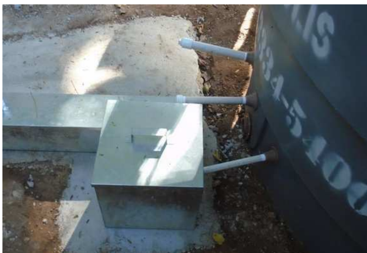
Figura 7.22: Tubo de saída no canal vertedor de saída do M-RNE
