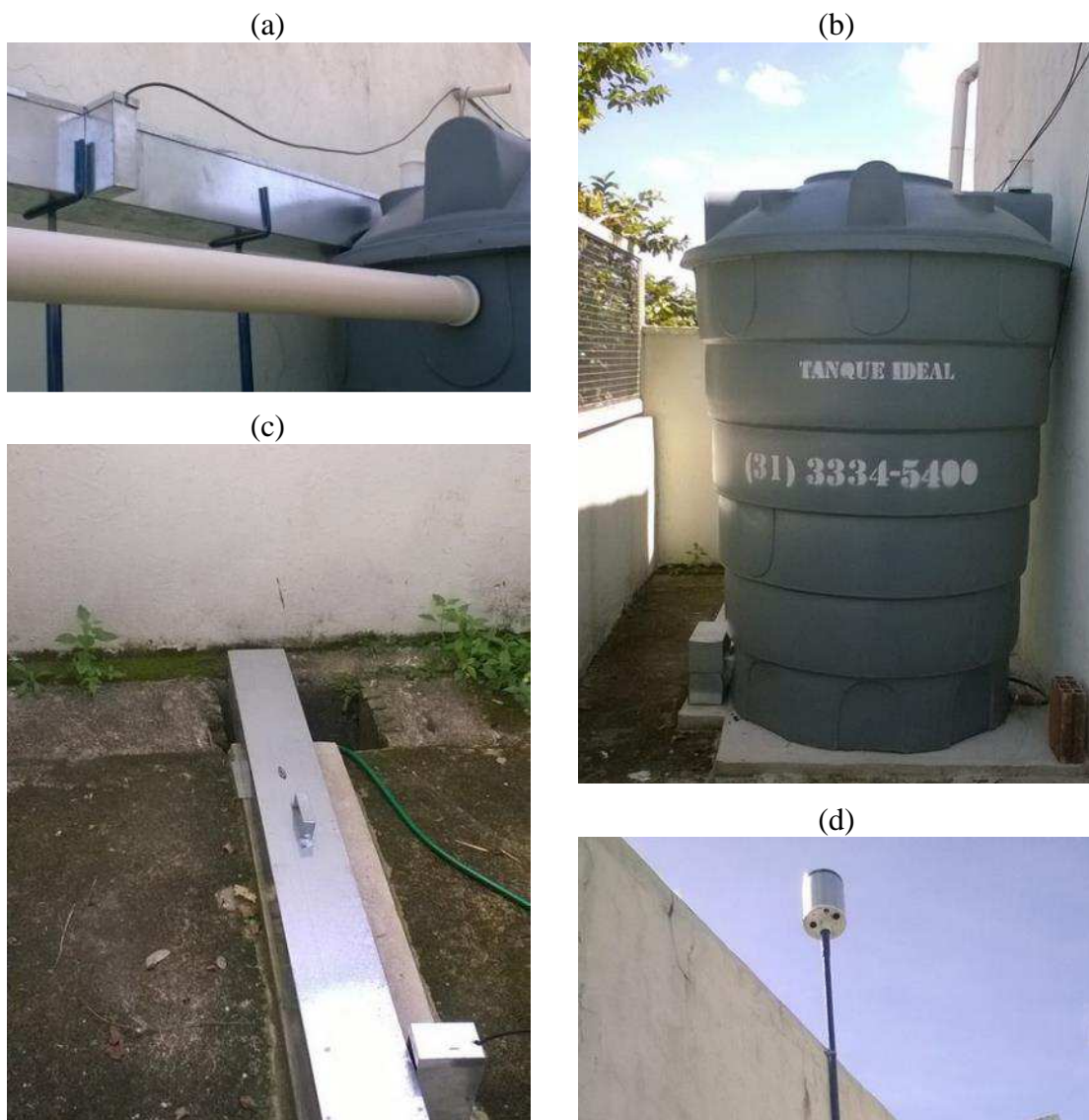
Figura 7.16: Experimento instalado no Centro de Saúde Prof. Amílcar V. Martins (a) Canal de entrada e Tubo extravasor (b) Microrreservatório (c) Canal de saída e Mangueira de descarga (d) Pluviômetro
