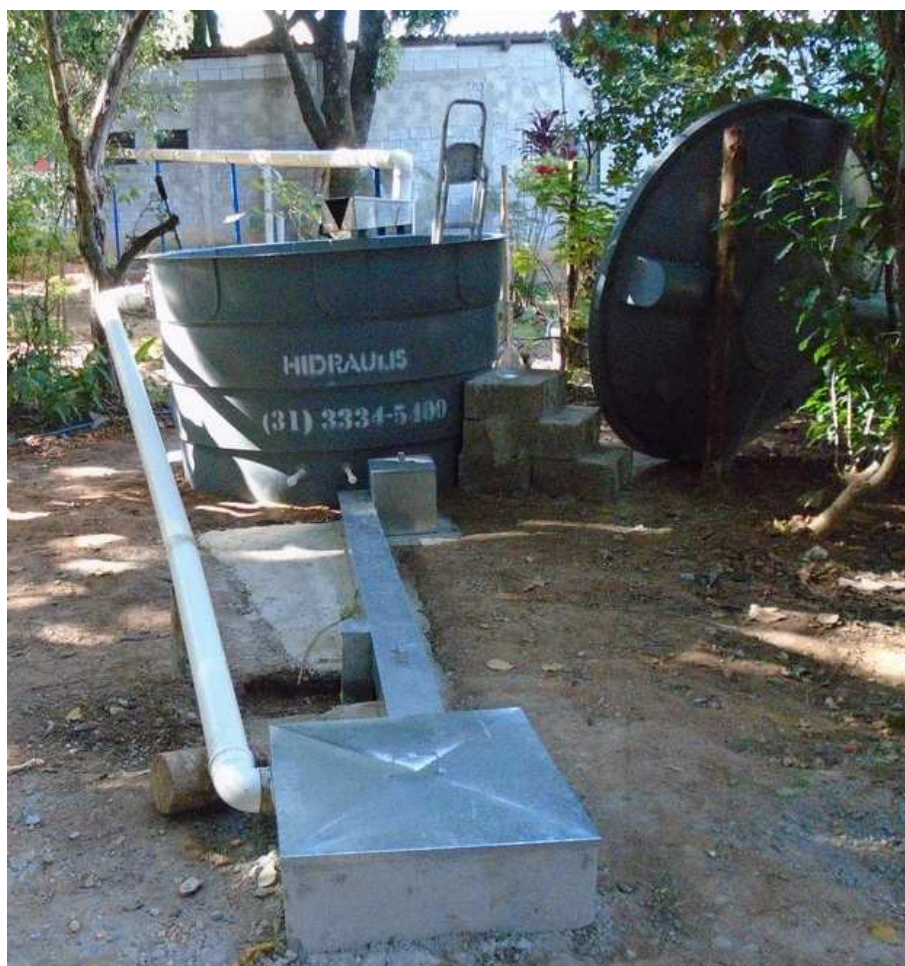
Figura 7.23: Experimento instalado na Sede da Regional Nordeste
