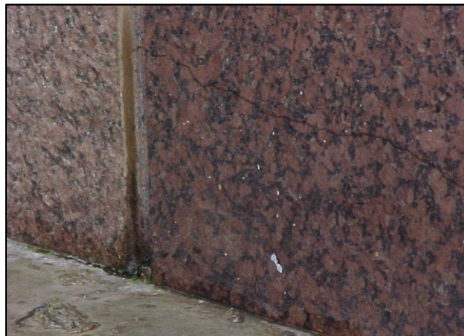
FIGURA 25: Fissuras nas placas de granito.
