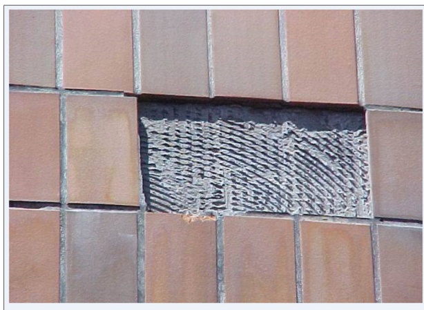
FIGURA 31: Efetiva separação entre a argamassa de assentamento e o substrato
