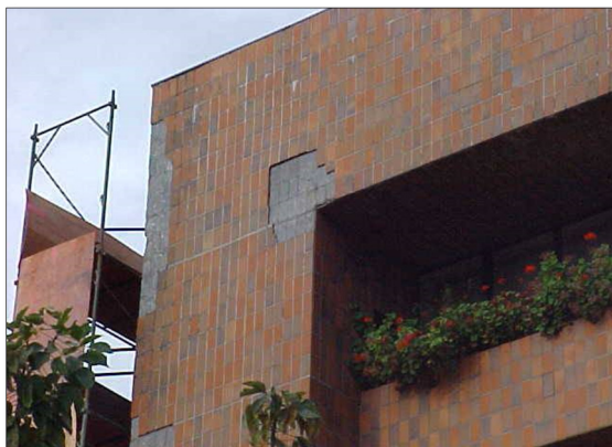
FIGURA 1: Deslocamento de revestimento na fachada do Edifício “B”
