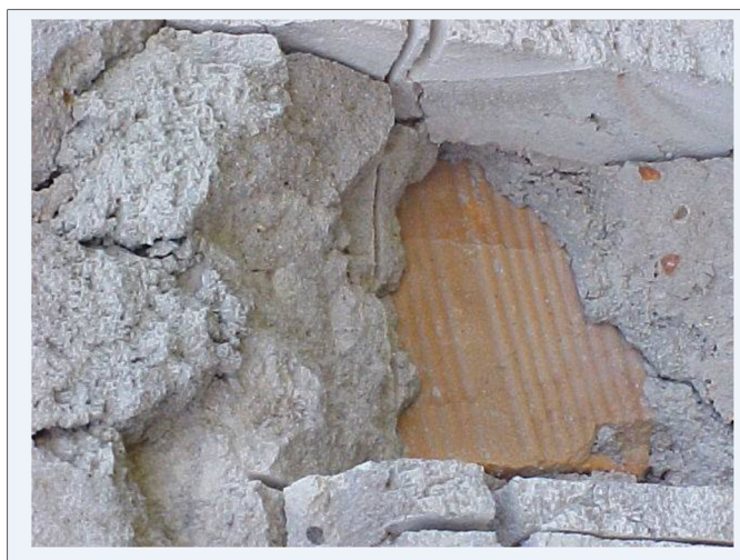
FIGURA 32: Falha na Aplicação do Chapisco, Emboço e Aplicação da Argamassa Colante.
