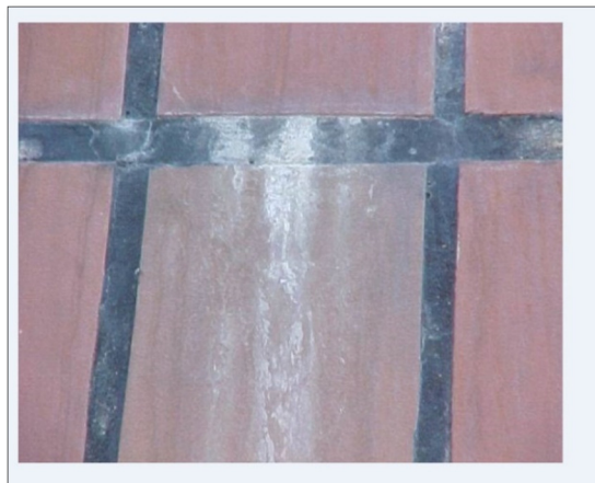
FIGURA 30: Eflorescência na Fachada
