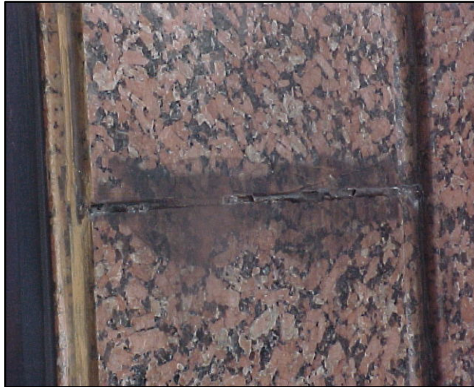
FIGURA 24: Falhas no rejuntamento.
