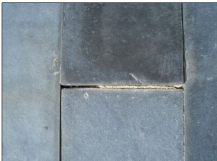
FIGURA 19: Exemplo de deterioração de juntas.
