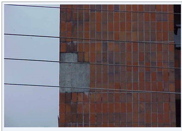
FIGURA 29: Deslocamento cerâmico na Fachada
