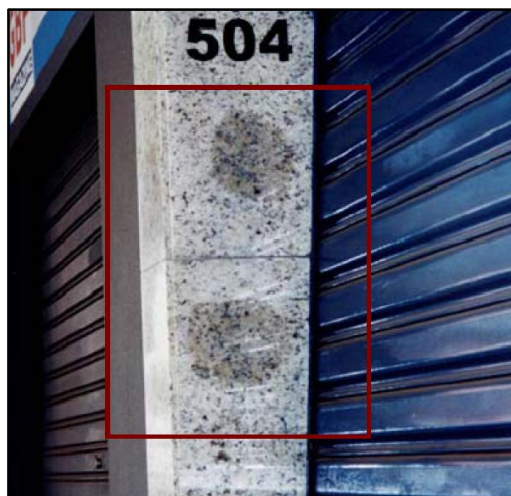
FIGURA 16: Exemplo de mancha de umidade.
