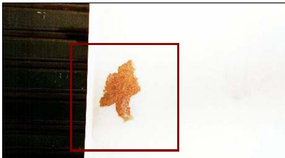
FIGURA 15: Exemplo de modificação da coloração original de uma placa pétreas. Mancha causada por hidróxido e óxido de ferro provenientes da porta de aço.
