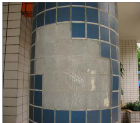
FIGURA 2: - Deslocamento de revestimento em pilar de fachada.
