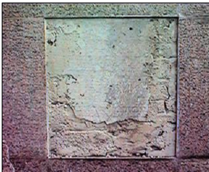
FIGURA 23: Descontinuidade da argamassa.
