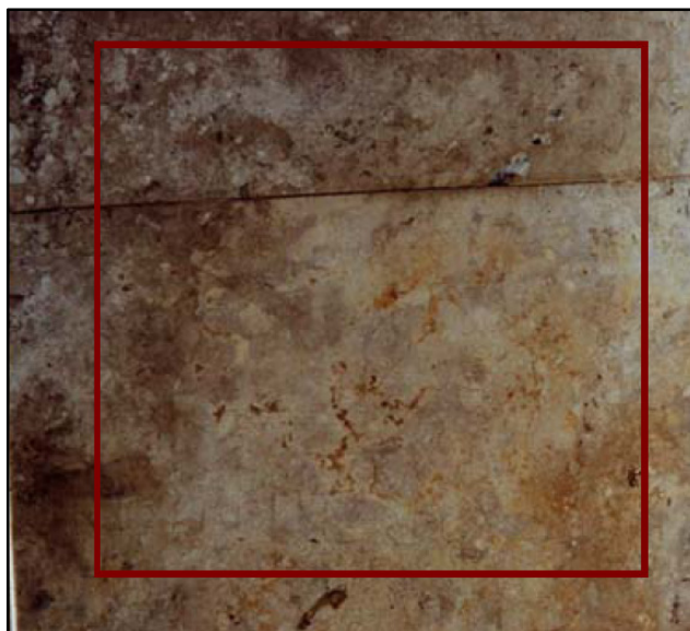
FIGURA 17: Exemplo de revestimento pétreo deteriorado.
