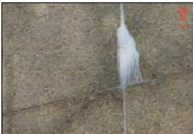
FIGURA 14: Eflorescência em revestimento de fachada com placa de rocha.
