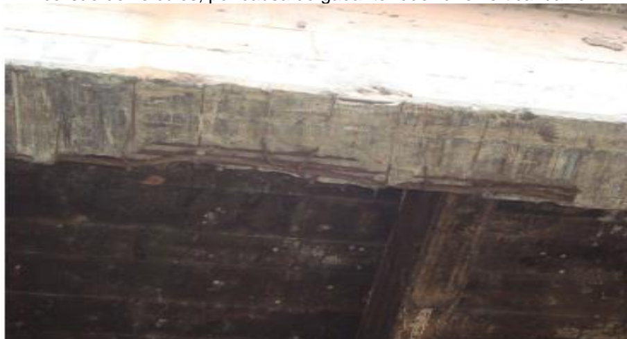
Figura 33 - Longarina lateral esquerda com concreto quebrado, armadura exposta e oxidada, devido colisão de veículos, por causa do gabarito rodoviário vertical baixo.
