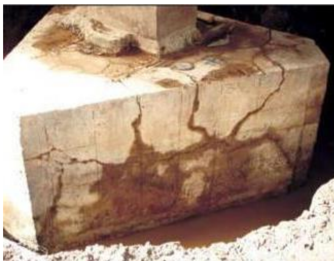
Figura 10 - Exemplo de Reação Álcali Agregado em pilar de ponte.
