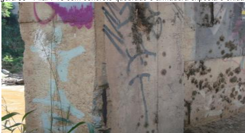
Figura 35 - Pilar P15 com concreto quebrado e armadura exposta e oxidada.
