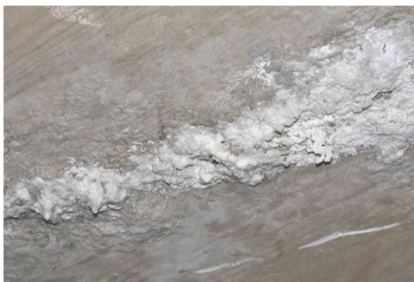
Figura 9 - Exemplo de lixiviação na superfície de concreto.
