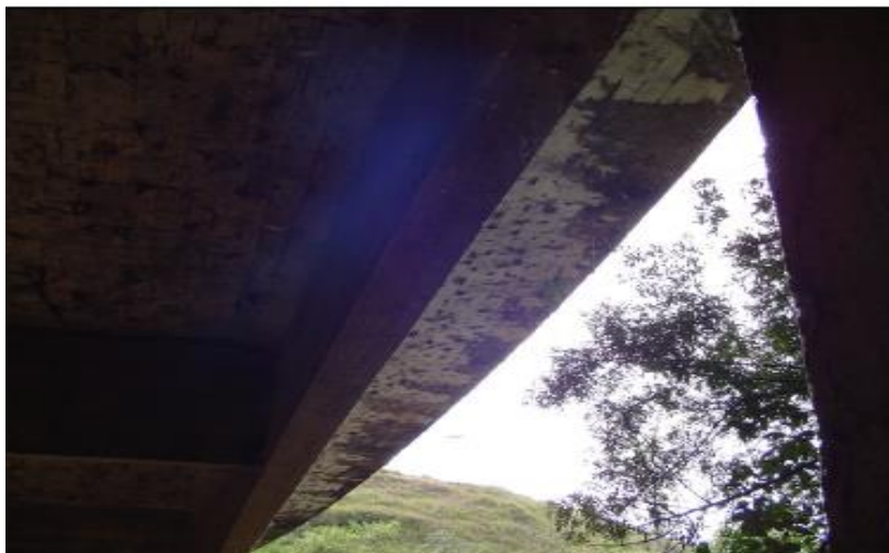
Figura 25 - Vista inferior lateral direita sentido MG-030 - Raposos
