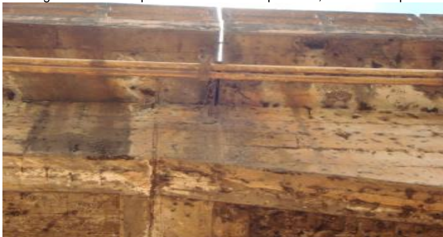
Figura 32 - Longarina lateral esquerda com concreto quebrado, armadura exposta e oxidada.
