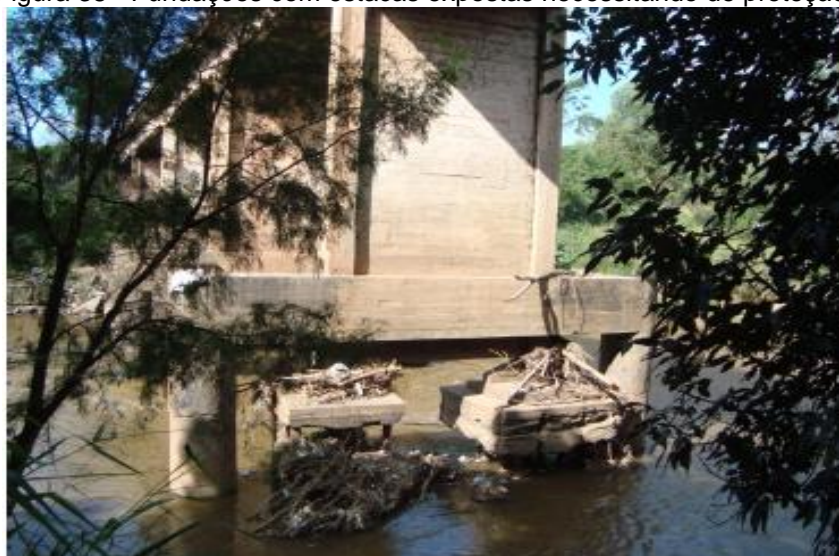
Figura 38 - Fundações com estacas expostas necessitando de proteção.
