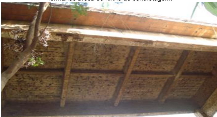
Figura 34 - Longarina lateral direita e esquerda com concreto quebrado armadura exposta e oxidada, formando broca ou ninho de concretagem.
