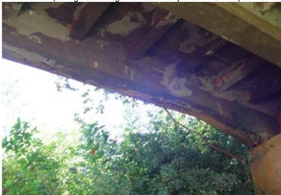
Figura 19 - Vista inferior (da laje e da longarina lateral esquerda do 6º vão) sentido Cardeal Mota
