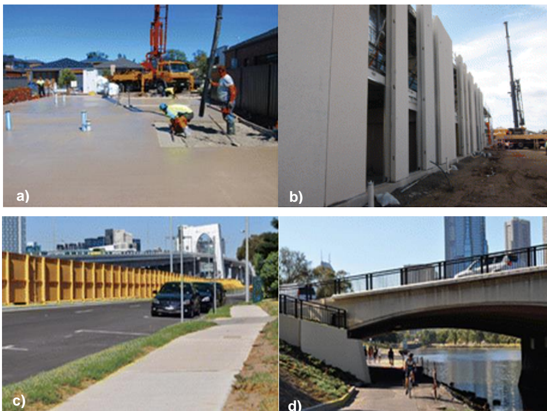
Figura 24: Obras com geopolímeros na Austrália (a) Piso/Laje de habitação residencial, (b) Painéis externos pré-moldados de uma edificação, (c) calçadas e (d) muro de contenção em torno de uma ponte rodoviária. Fonte: PROVIS e BERNAL (2014)
