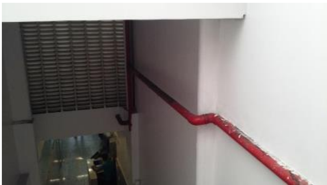
Figura 5.9: Tubulação Hidrante Fonte: Fotografia Tiago Junio, 2016.
