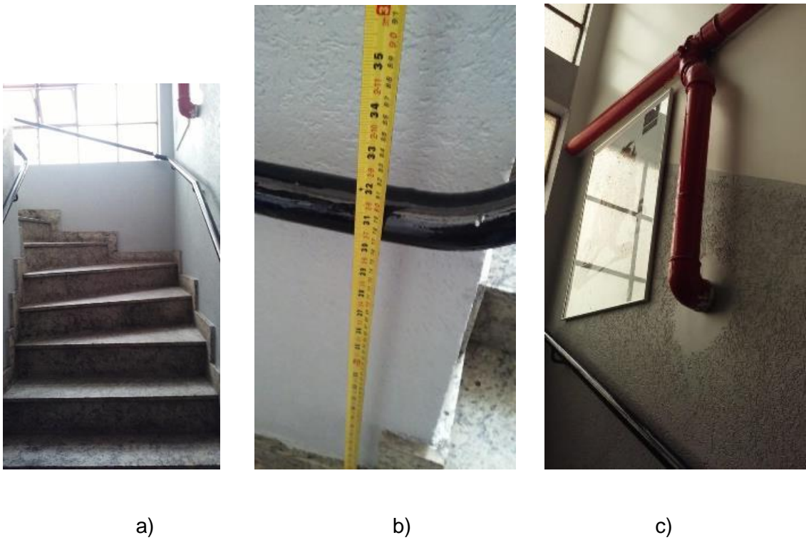
Figura 5.10: a) Hall de Escada; b) Corrimão Hall de Escada; c) Tubulação Hidrante Fonte: Fotografia Tiago Junio, 2016.
