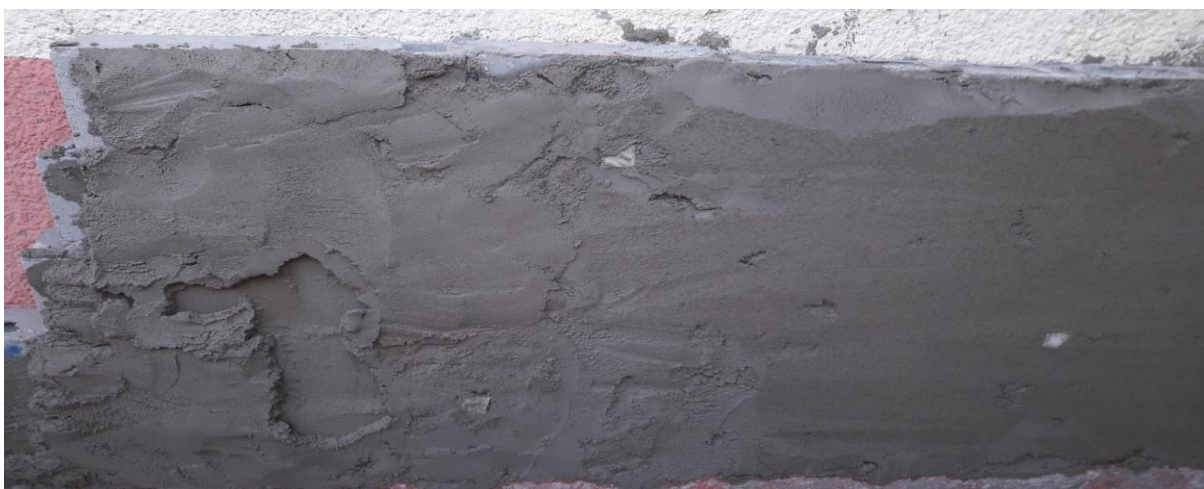
Figura 13 – Argamassa se soltando do painel de teste. Fonte: (autor)
