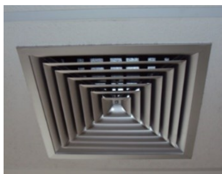
Figura 24: Difusor do ar condicionado
