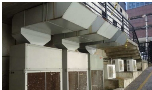
Figura 27: Condicionadores de ar
