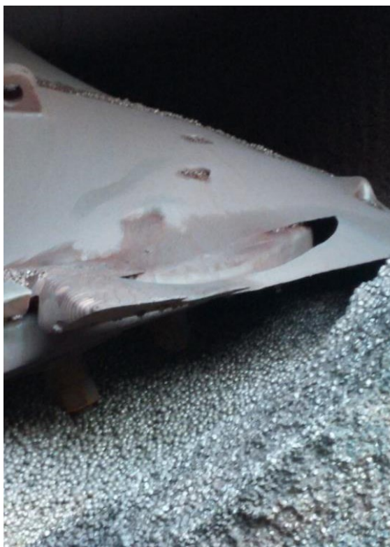
Figura 3.14 - Desgaste excessivo do revestimento inferior (acervo do autor).
