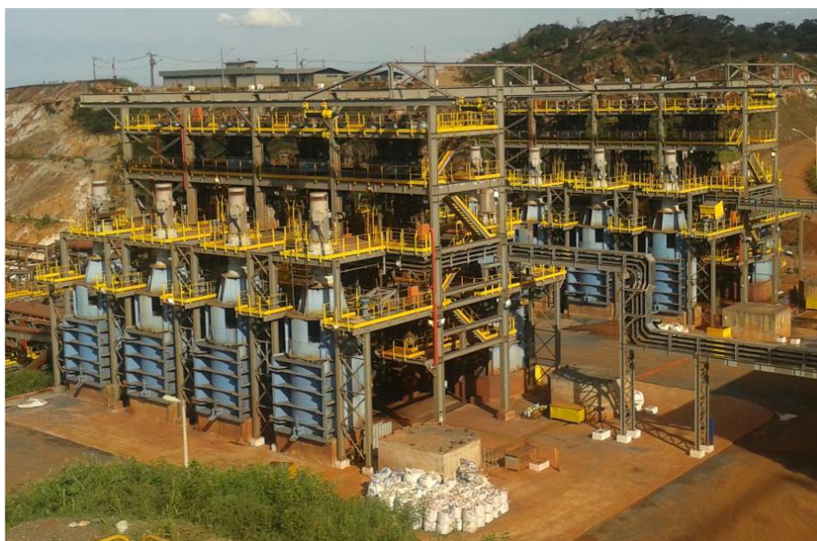
Figura 3.3 - Circuito de remoagem do Minas-Rio: cada prédio corresponde a uma linha de remoagem composta por oito moinhos e quatro baterias de hidrociclones classificando o concentrado em circuito fechado (acervo do autor).
