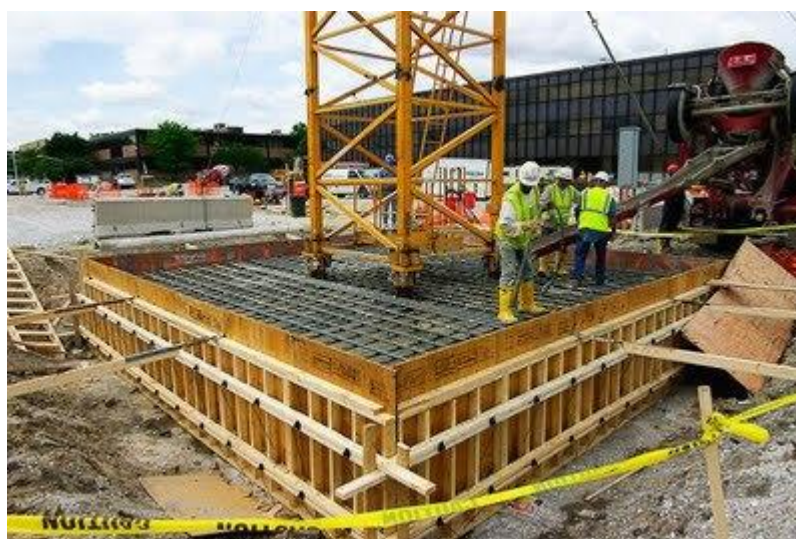
Figura 1: Base de concreto da grua. Fonte: Blog Engenharia Estrutural e Construção Civil, 2012.
