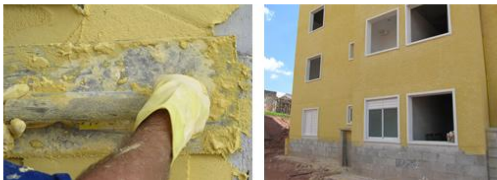
Figura 6: ARDM sendo aplicada e em seguida edifício após sua aplicação. Fonte: Portal AECweb.
