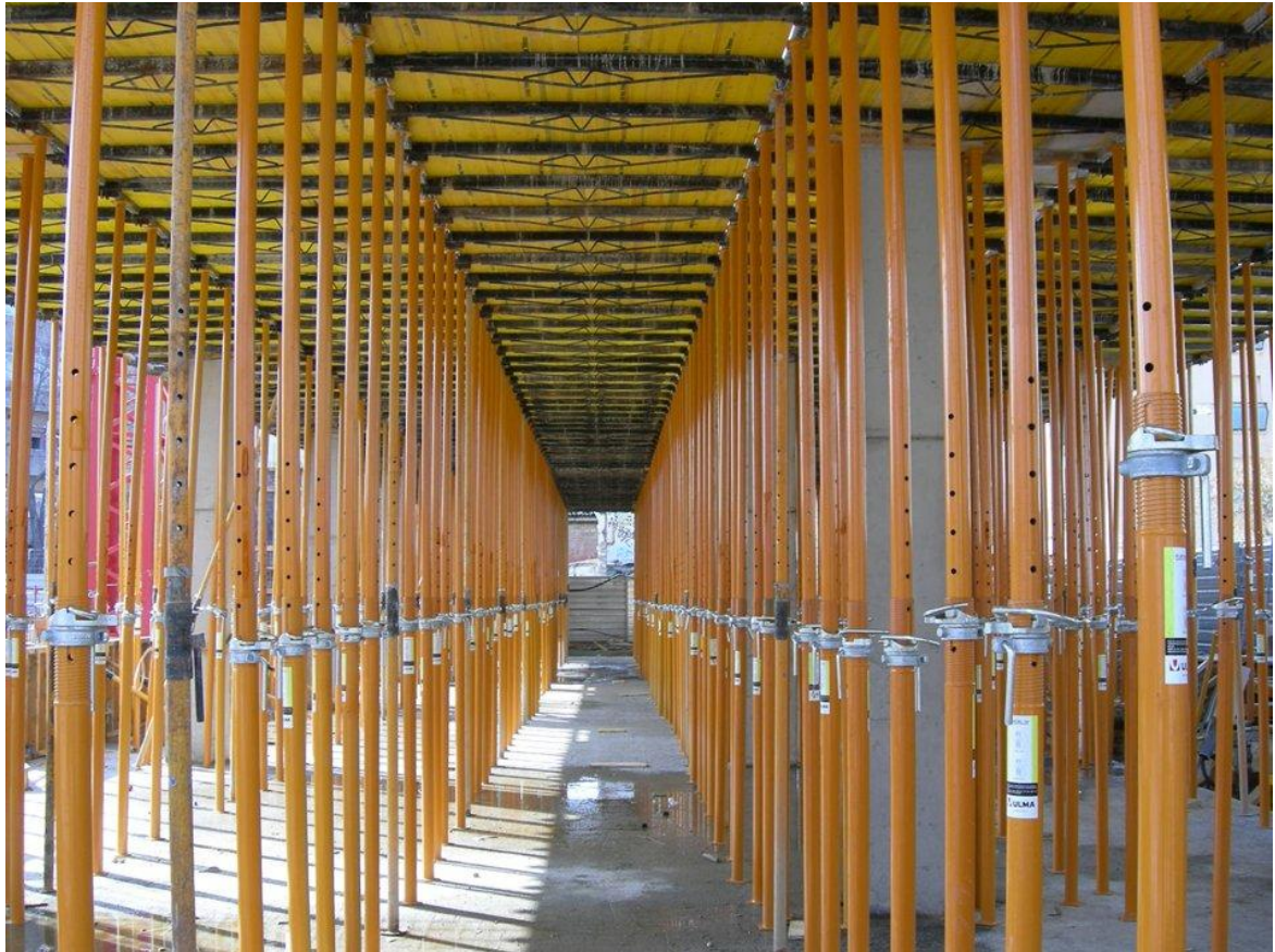
Figura 12: Ambiente limpo com as escoras metálicas em uso. Fonte: Portal Sistema de Armazenagem.
