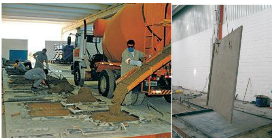
Figura 19: Concretagem e içamento das paredes da célula em concreto armado. Fonte: Revista Techné, Ed. 159 junho/2010.
