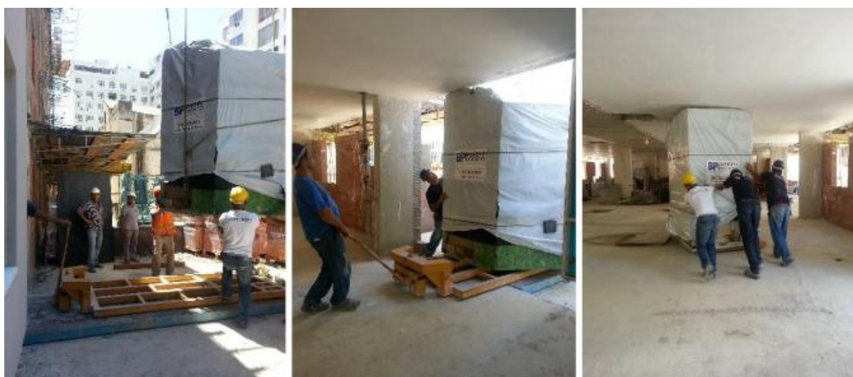
Figura 23: Grua posicionando o banheiro no “carrinho” e módulo sendo deslocado pelo pavimento. Fonte: PRINHEIRO, 2015.
