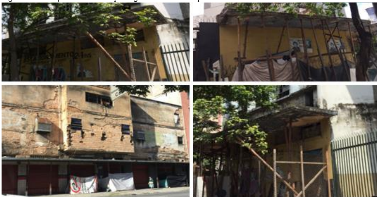
Figura 21: Marquises em avançado grau de deterioração
