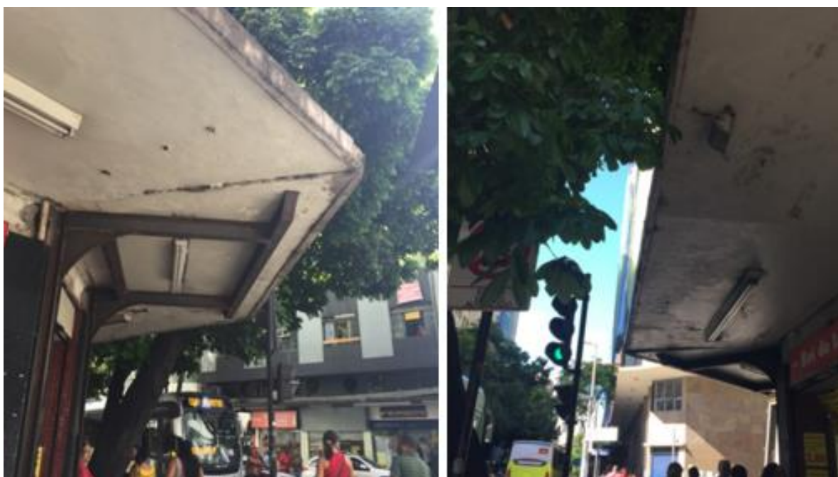
Figura 23: Marquise apoiada por mão francesa adaptada à estrutura para reforço
