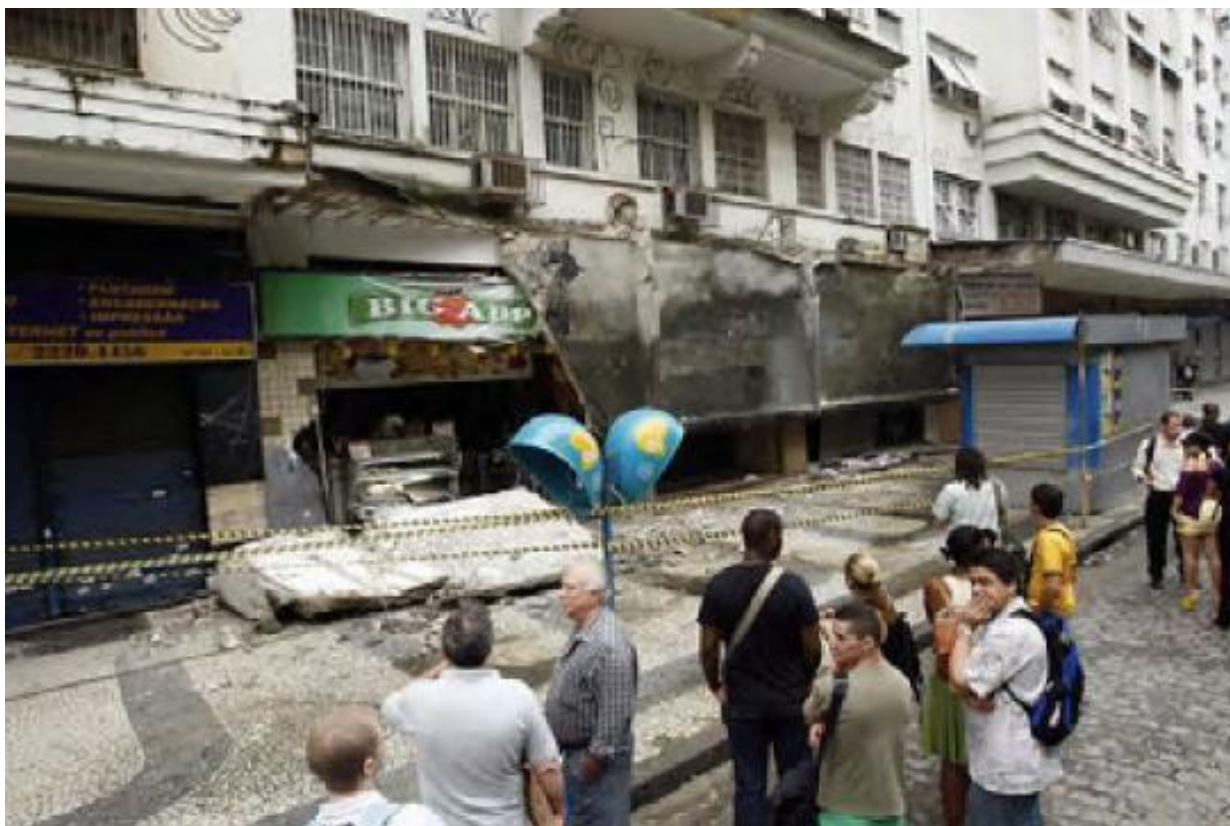
Figura 11: Desabamento de marquise Av. Churchill.
