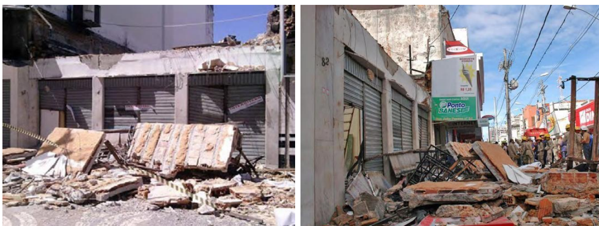
Figura 12: Desabamento em Aracaju no ano de 2010
