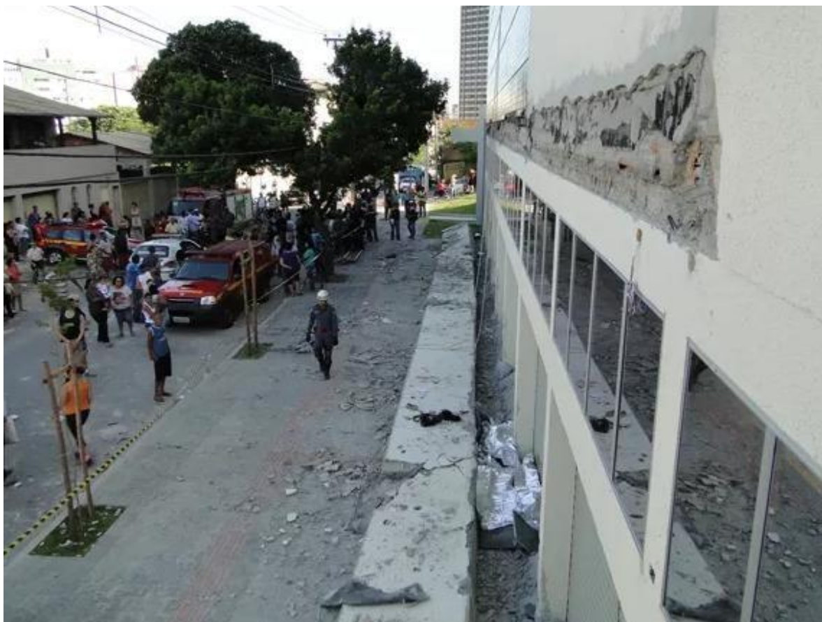
Figura 15: Desabamento de marquise na cidade de Belo Horizonte
