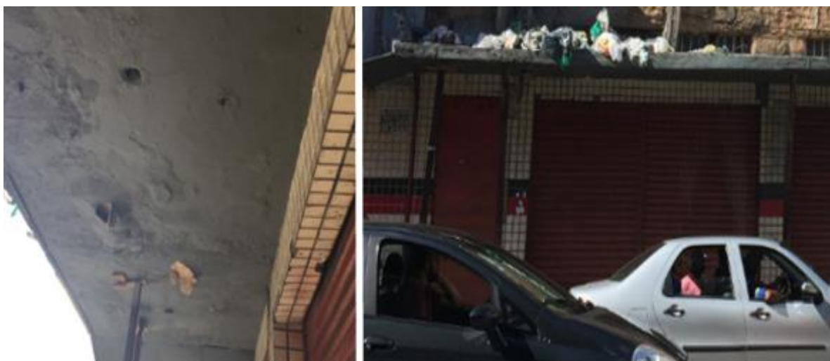
Figura 22: Marquise com pintura realizada na face interna deteriorada
