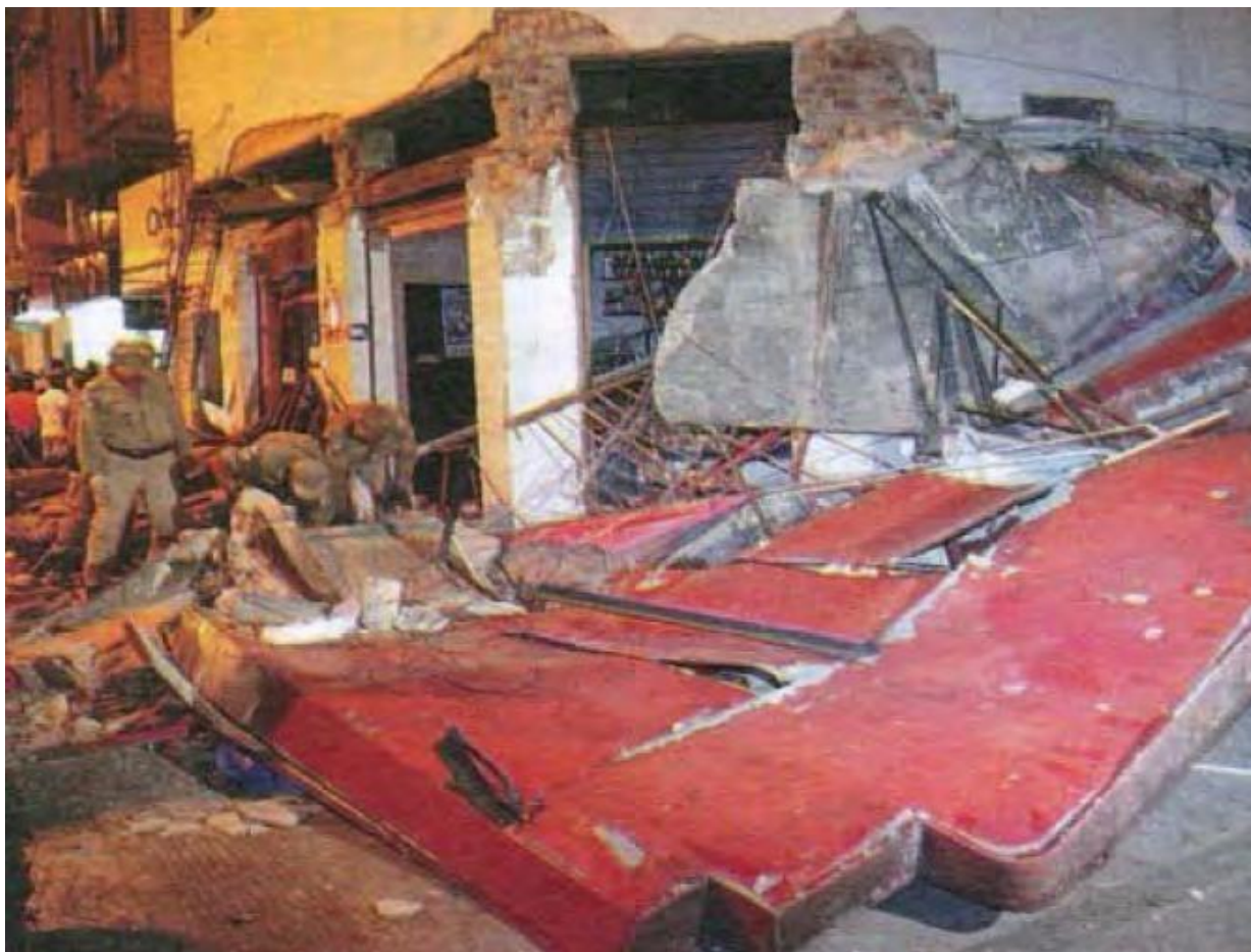
Figura 9: Desabamento da marquise do Bar Parada Obrigatória
