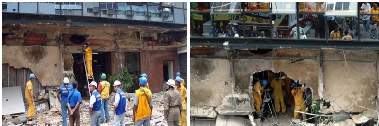
Figura 10: Desabamento de marquise do Hotel Canadá
