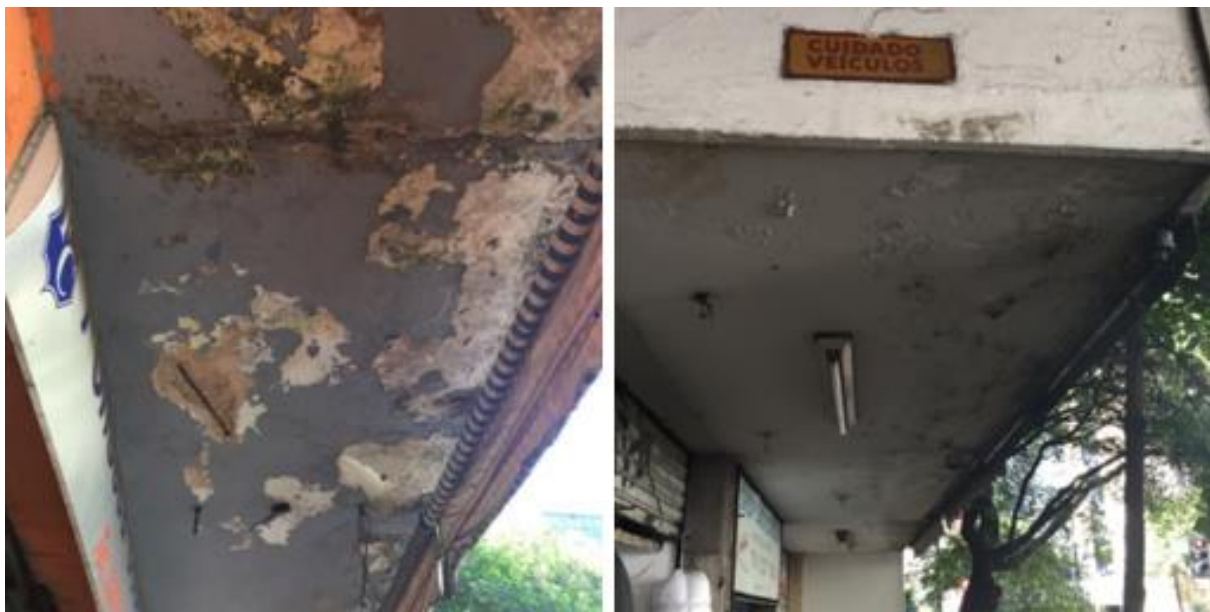
Figura 20: Marquises com evidente deterioração das armaduras
