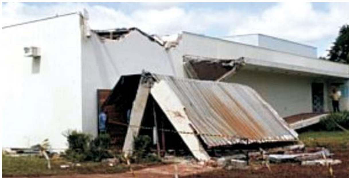
Figura 13: Desabamento da marquise da Universidade Estadual de Londrina
