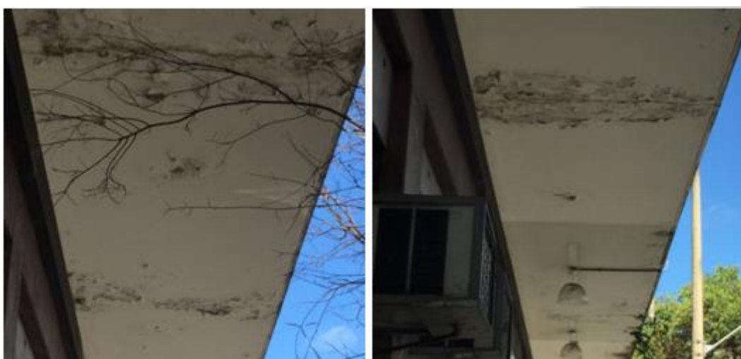
Figura 17: Marquises com infiltrações e fungos
