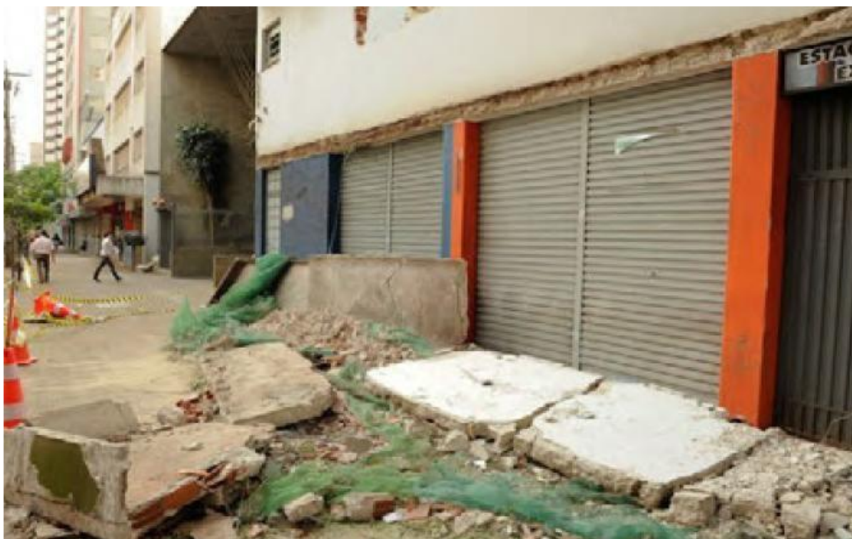
Figura 14: Desabamento de marquise na cidade de Maringá
