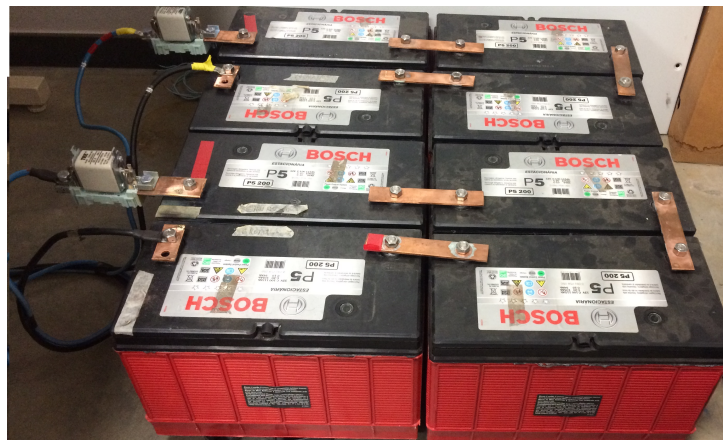
Figura 2.8: Bancos de Baterias.
