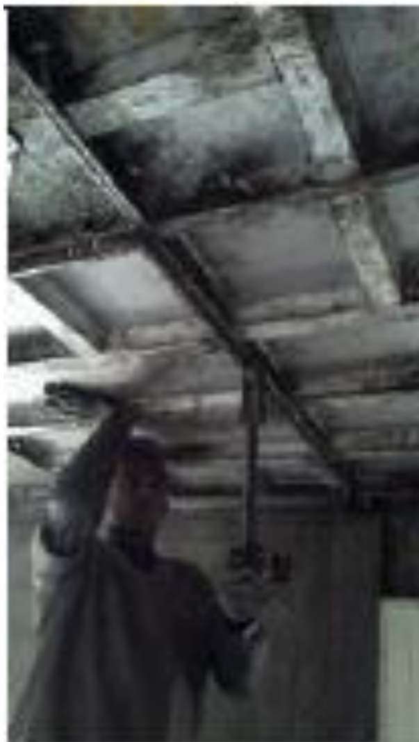
Figura 48 - Desforma da laje Fonte: da pesquisa, 2015.
