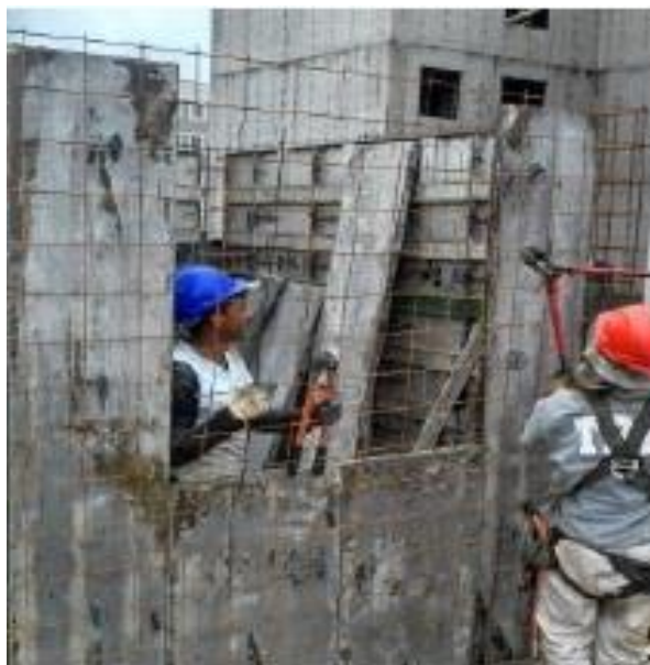
Figura 37 - Armador cortando tela de aço para vão de janela. Fonte: da pesquisa, 2015.
