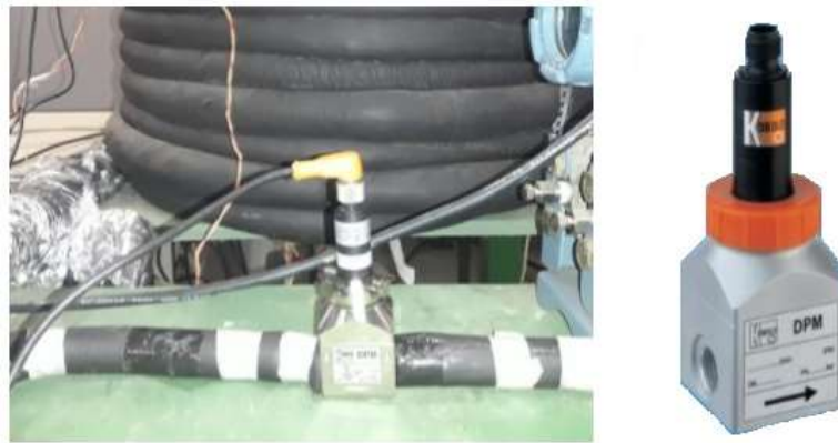
Figura 3.10: Medidor de vazão.
