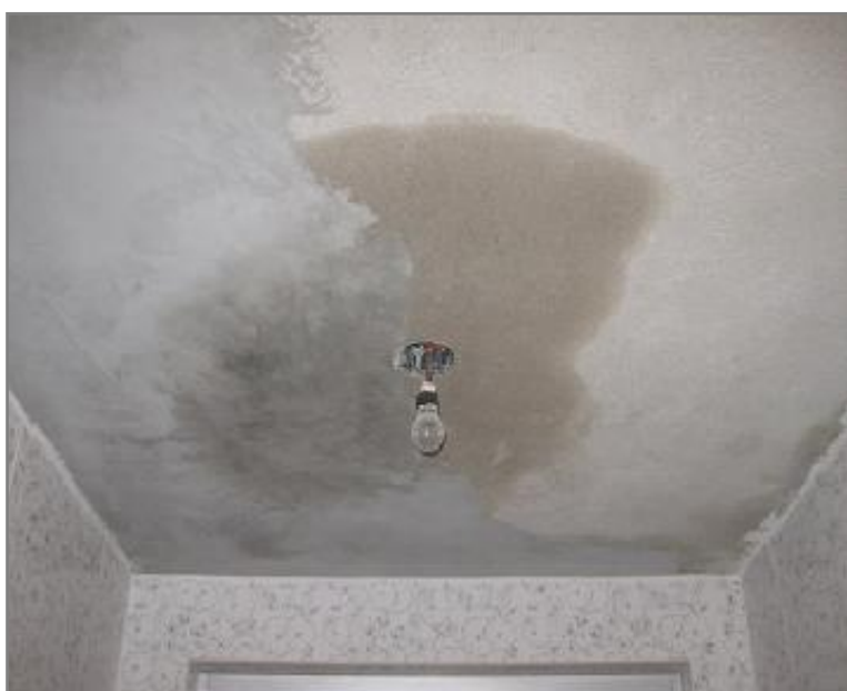
Figura 19 – Teto do banheiro, área interna Fonte: Residência em Belo Horizonte, 2012
