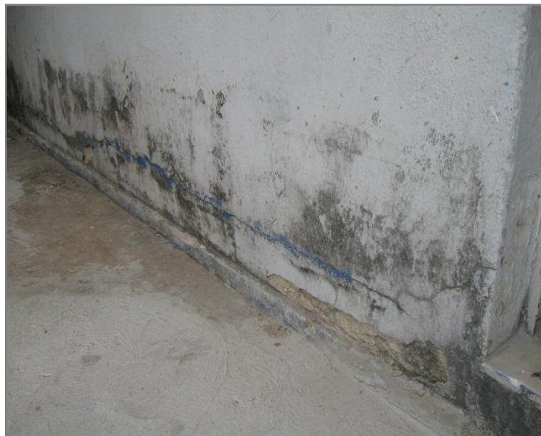
Figura 23 – Parede residência dos fundos, área externa Fonte: Residência em Belo Horizonte, 2012
