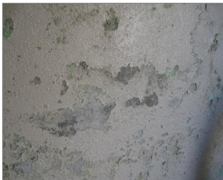
Figura 25 – Parede residência dos fundos, área interna Fonte: Residência em Belo Horizonte, 2012
