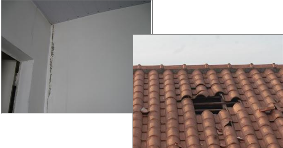
Figuras 21 e 22 – Parede da cozinha e telhado casa Fonte: Residência em Belo Horizonte, 2012
