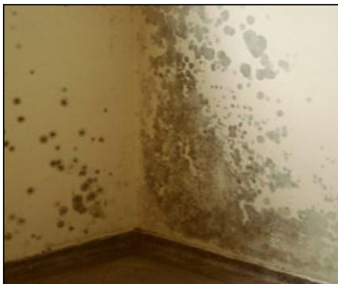
Figura 15 – Mofo ou bolor Fonte: Residência em Belo Horizonte, 2012
