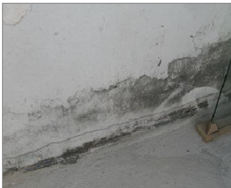
Figura 07 – Umidade ascendente por capilaridade Fonte: Residência em Belo Horizonte, 2012
