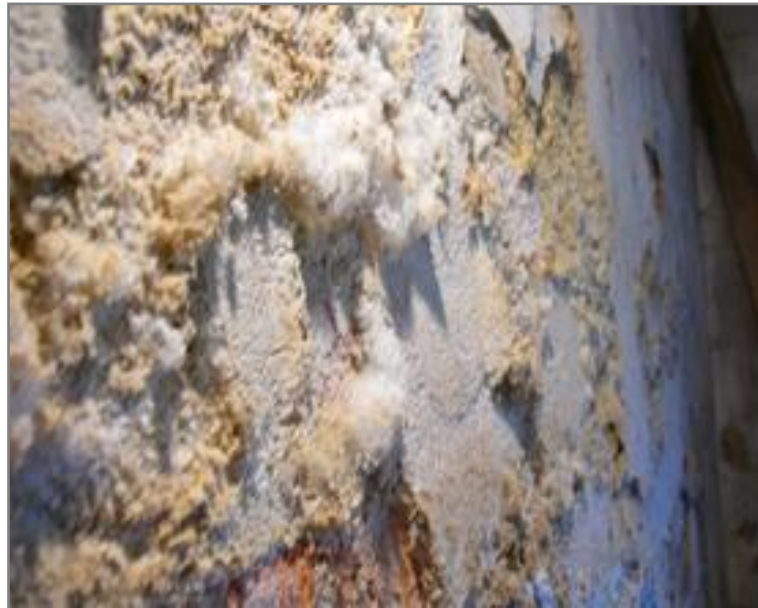
Figura 12 – Aspecto de eflorescências
