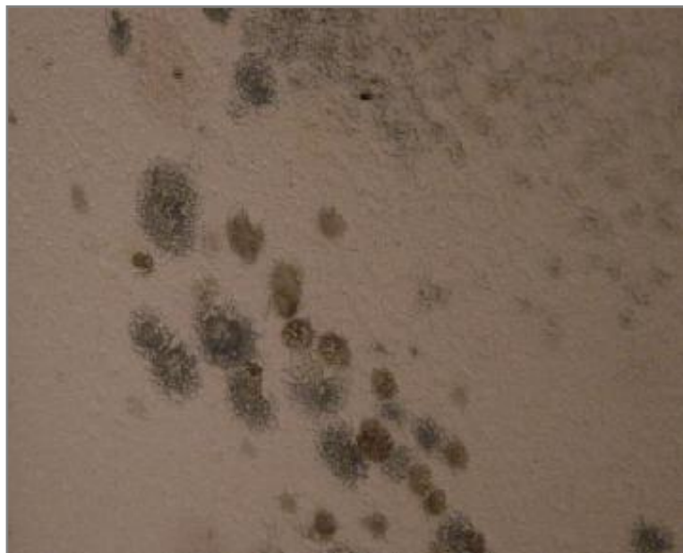
Figura 05 – Umidade por condensação Fonte: Residência em Belo Horizonte, 2012
