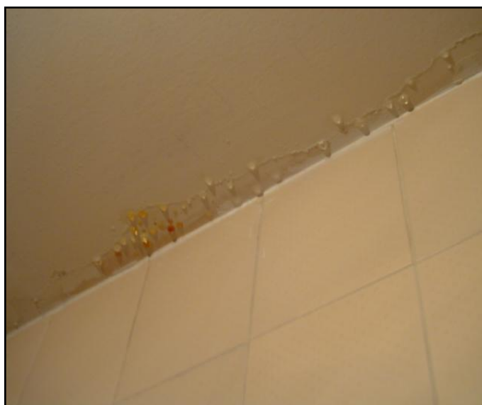
Figura 14 – Goteiras Fonte: Residência em Belo Horizonte, 2012
