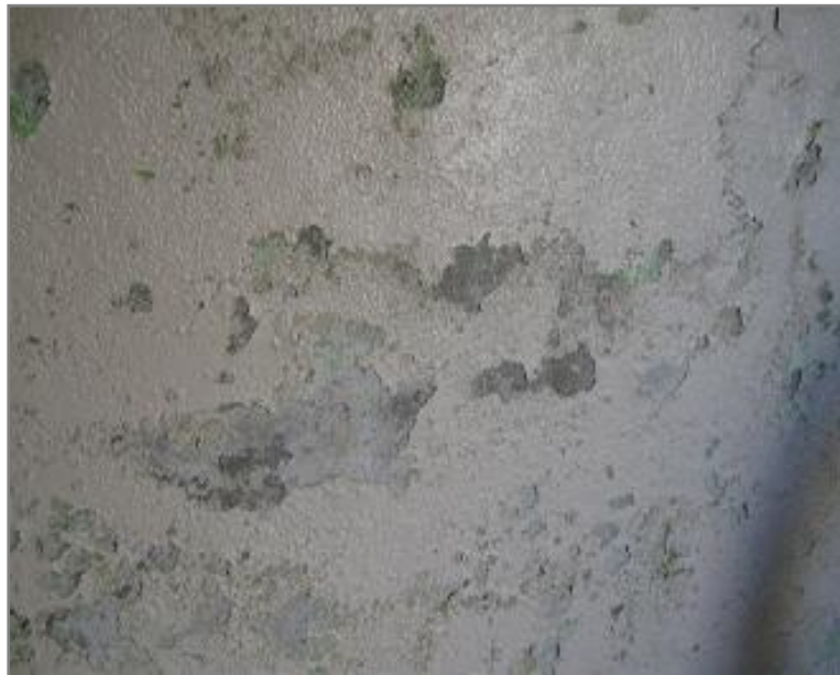
Figura 03 – Umidade por infiltração Fonte: Residência em Belo Horizonte, 2012
