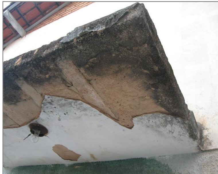
Figura 09 – Efeito da umidade por percolação Fonte: Residência em Belo Horizonte, 2012
