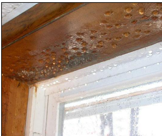
Figura 17 – Condensação Fonte: Residência em Belo Horizonte, 2012
