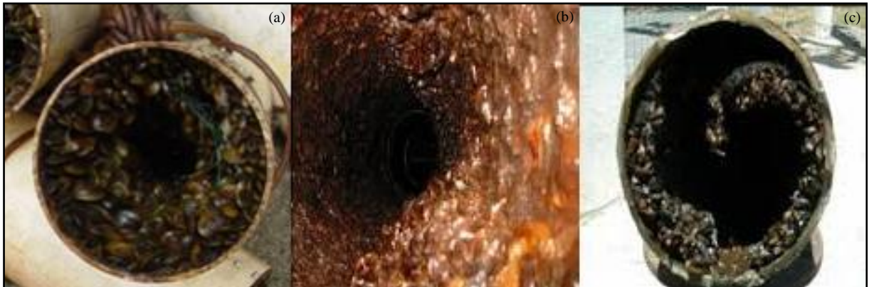
FIGURA 3 – Incrustação mexilhão dourado dentro de tubulações FONTE – (a) e (b) OLIVEIRA et al 2004 e (c) CORSAN (2008)
