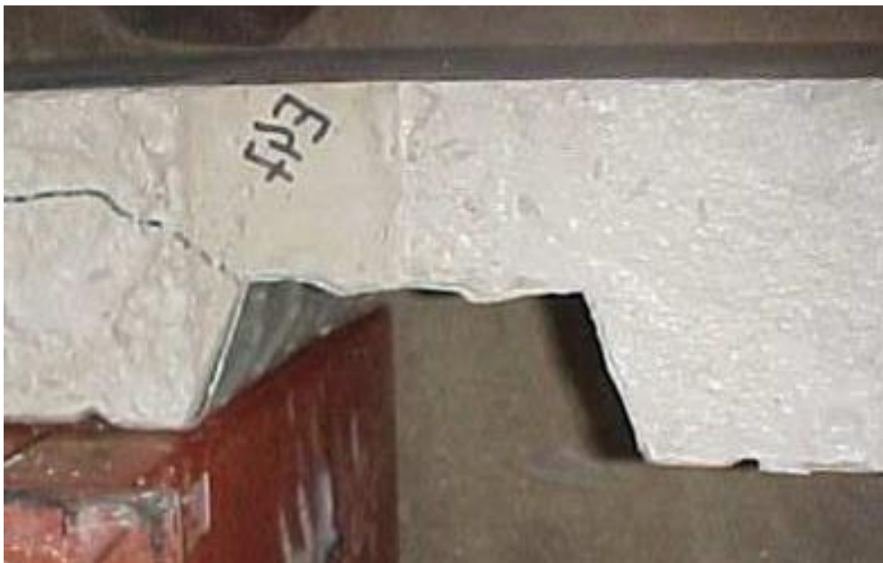
Figura 5.10: Superfície de falha averiguada no modelo experimental.
