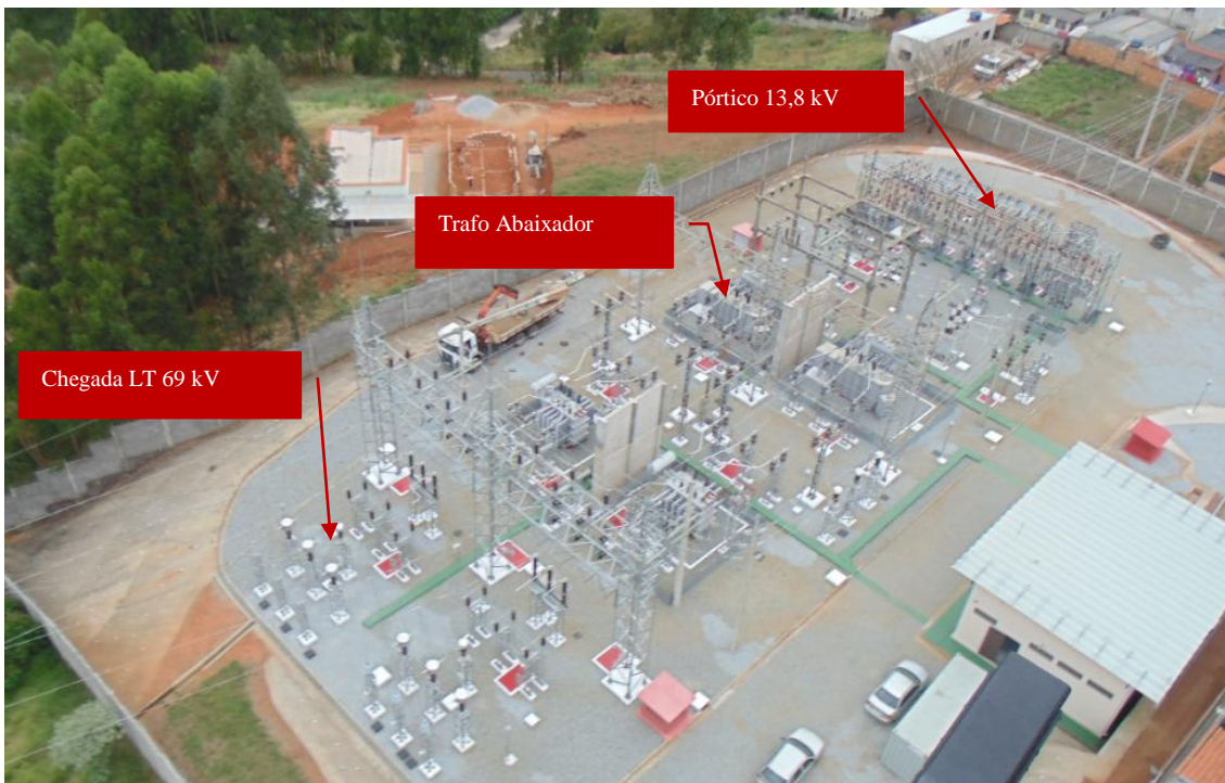
Figura 4.7: Vista Aérea SE Oliveira Fonte: CEMIG -D
