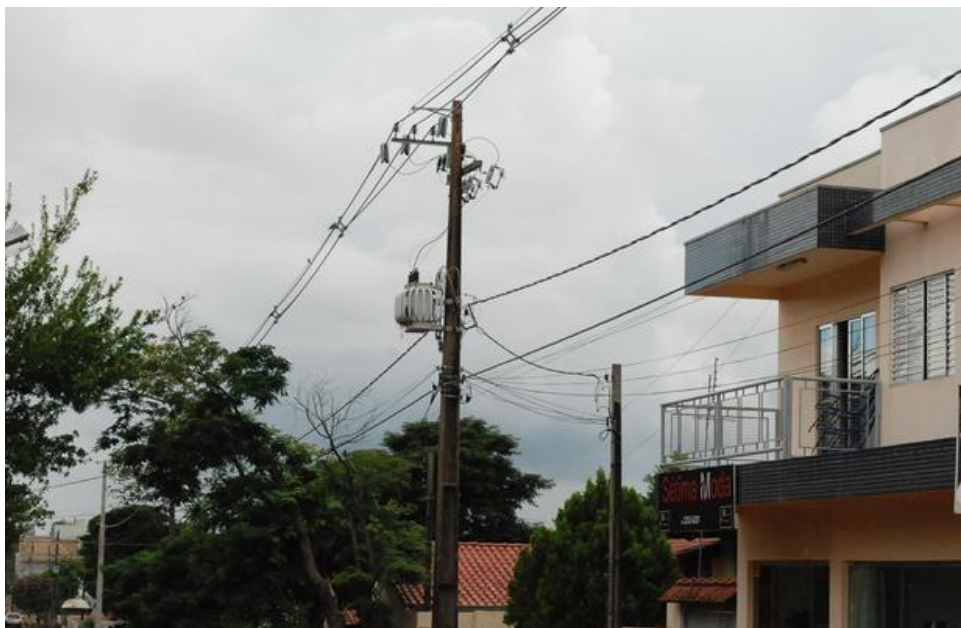
Figura 2. 1 - Rede de Distribuição de Energia. Fonte - COPEL, 2013.
