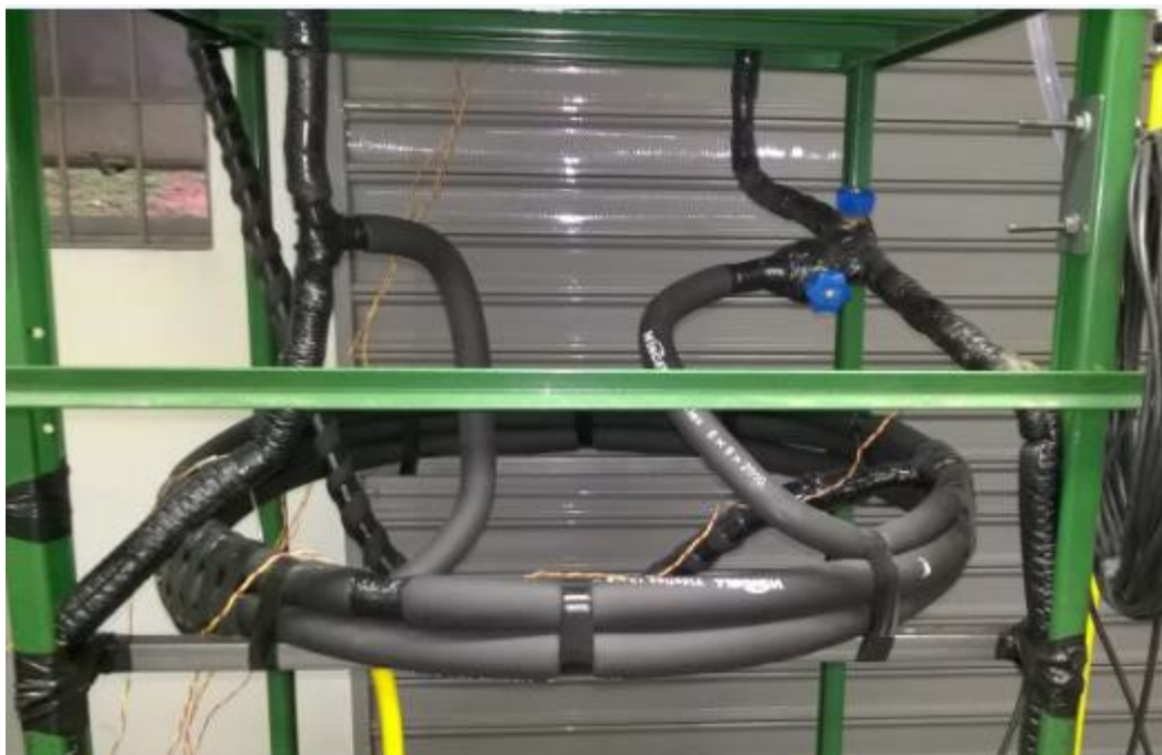
FIGURA 3.15 - Condensador instalado na bomba de calor. FONTE: DINIZ, 2017.
