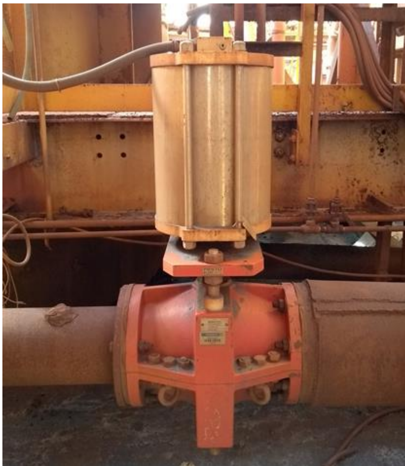
Figura 5.2. Válvula de controle da coluna scavenger subsequente ao estágio de flotação em células mecânicas de grande volume ( tank cells ).
