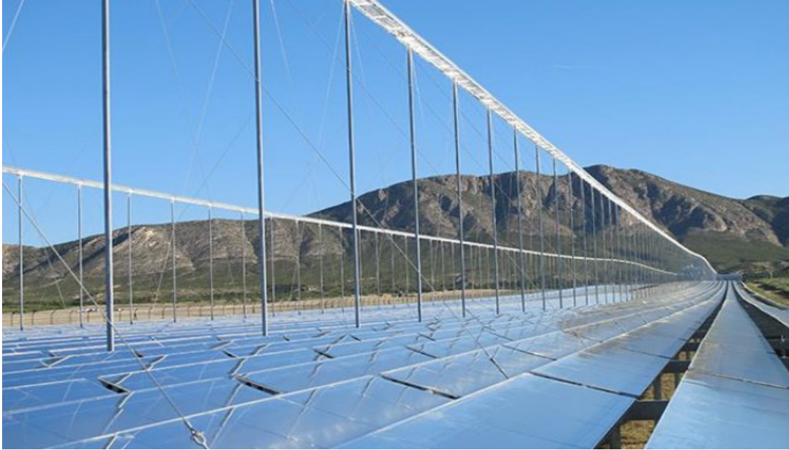
Figura 3 - Usina CSP Fresnel, Puerto Errado 2, Espanha.
