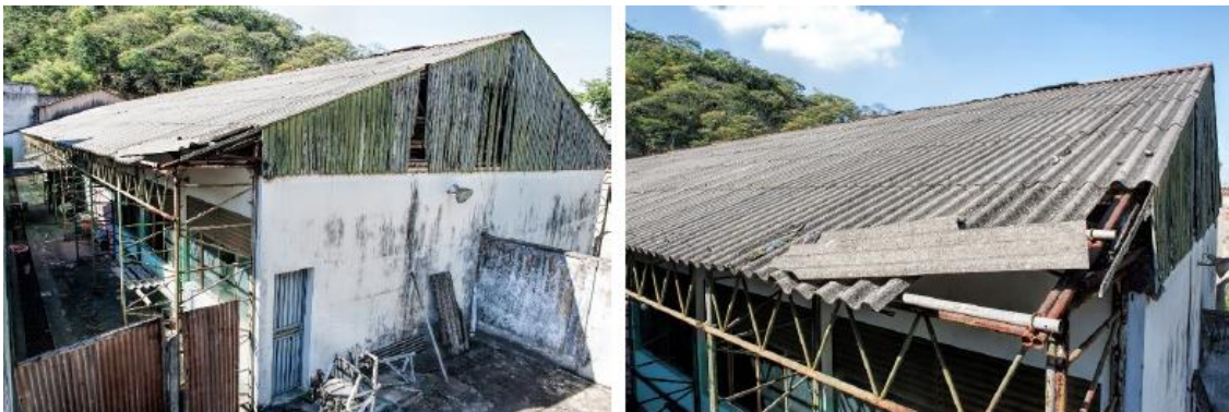
FIGURA 4 – PRECARIIDADE DO TELHADO E VEDAÇÃO EM MADEIRA
