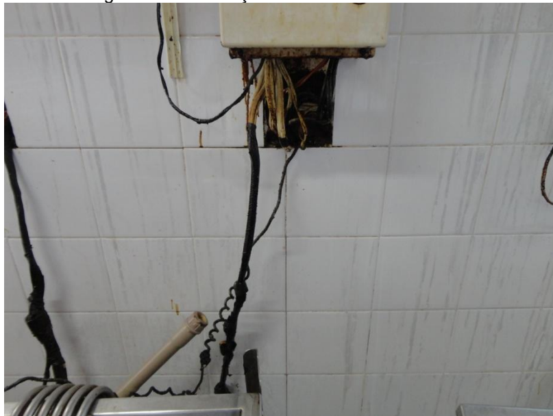
Figura 73 – Instalações das fritadeiras elétricas
