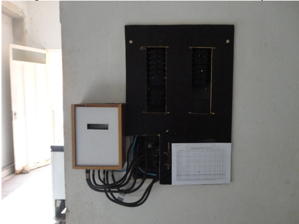
Figura 9 – Medidor do restaurante, localizado no interior da edificação
