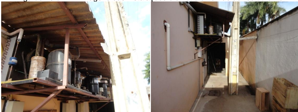
Figuras 10 e 11 – Imagens das instalações elétricas externas ao restaurante
