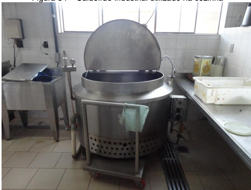
Figura 84 – Caldeirão industrial utilizado na cozinha
