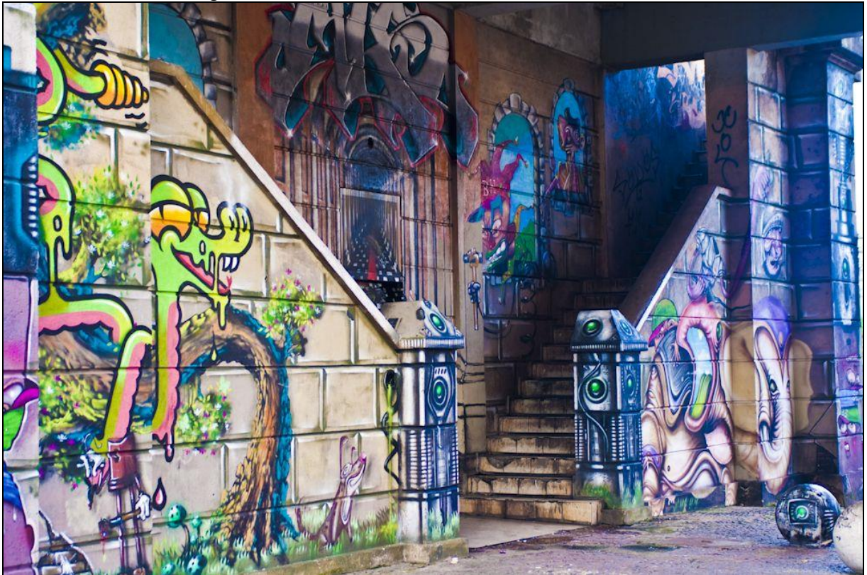
Figura 37 – Grafite no Viaduto de Santa Tereza.
