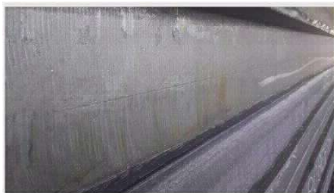
Figura 3.7– Foto de trinca longitudinal ao comprimento da placa no centro da espessura na seção de corte.
