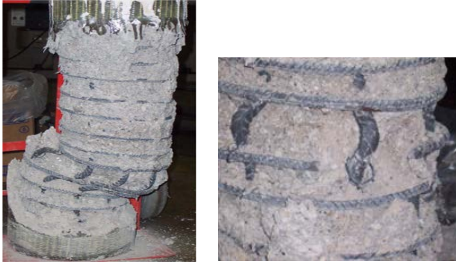
Figura 2.32 - Fratura em Espiral e Flambagem das Barras Longitudinais de Espécime Reforçado com Concreto Armado com Vergalhões
