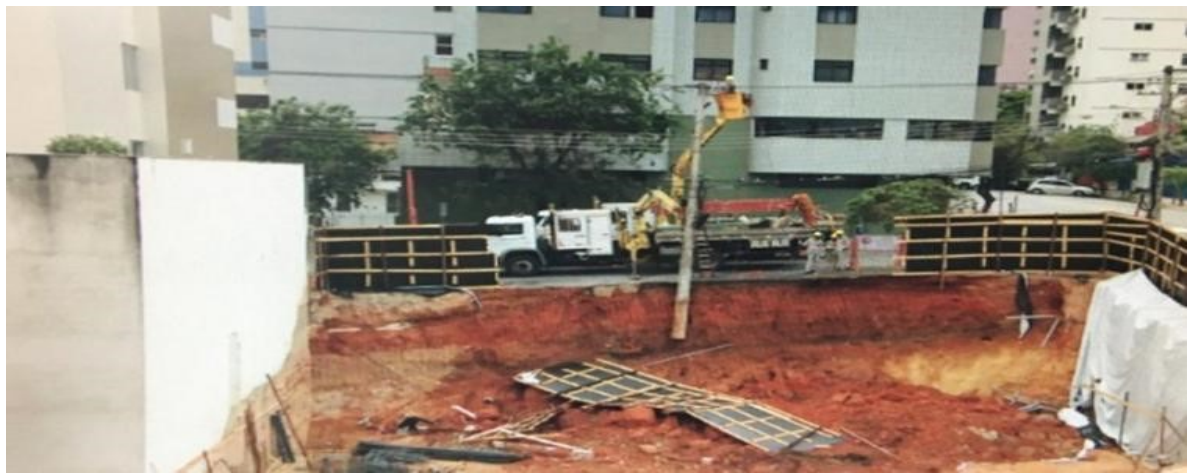
Figura 21- DESMORONAMENTO DE PARTE DA VIA / Fonte: Prefeitura de Divinópolis 17/01/2018
